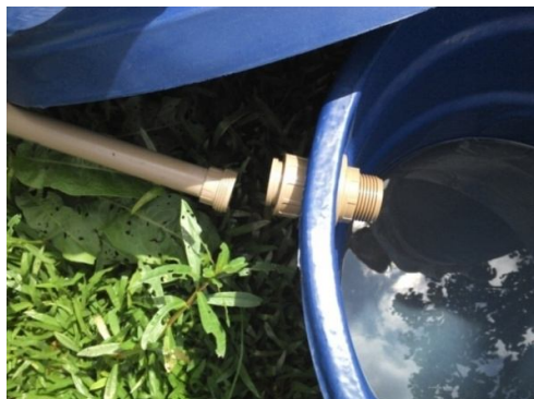
Figura 3211 - Caixa desconectada para esvaziamento
