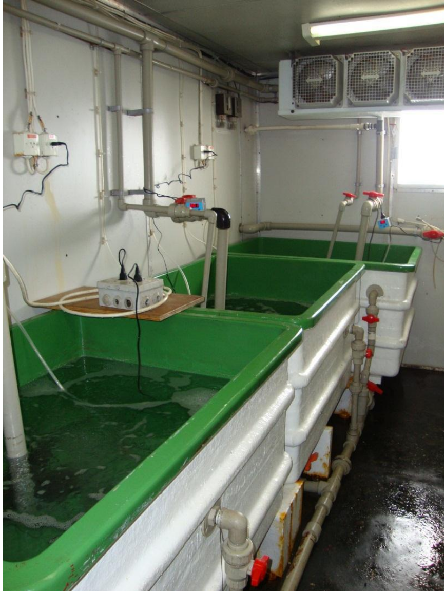
Figura 15. Módulo de Aquários - sala climatizada contendo os tanques de 1000 litros na Estação Comandante Ferraz (EACF). Foto: O autor, 2011.
