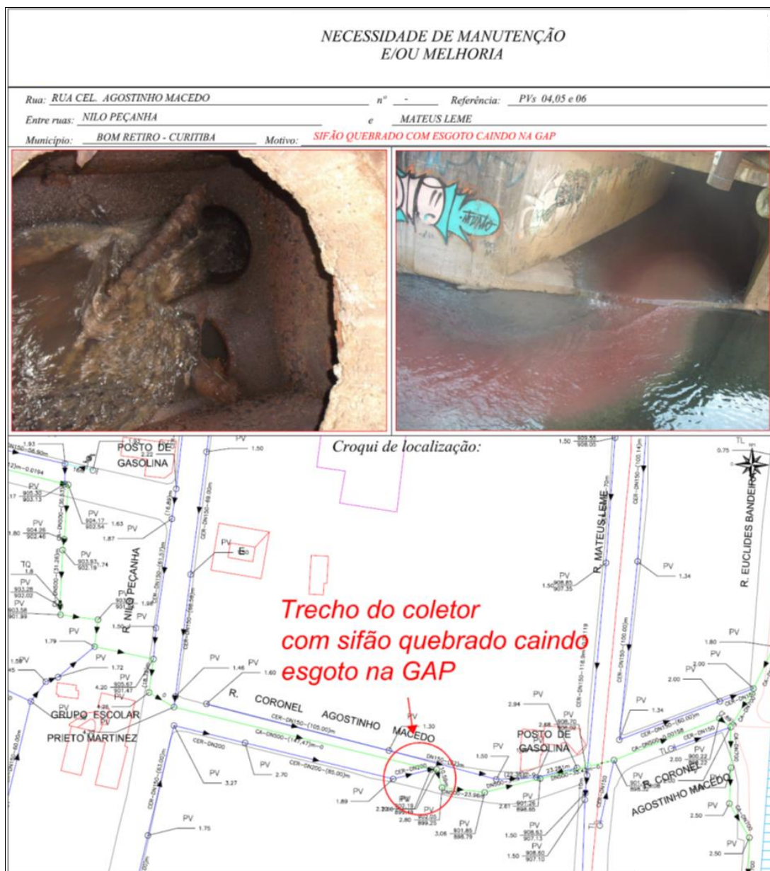
Figura 80 - Sistema coletor de esgoto danificado lançando na galeria pluvial. FONTE: SANEPAR USEG (2013)
