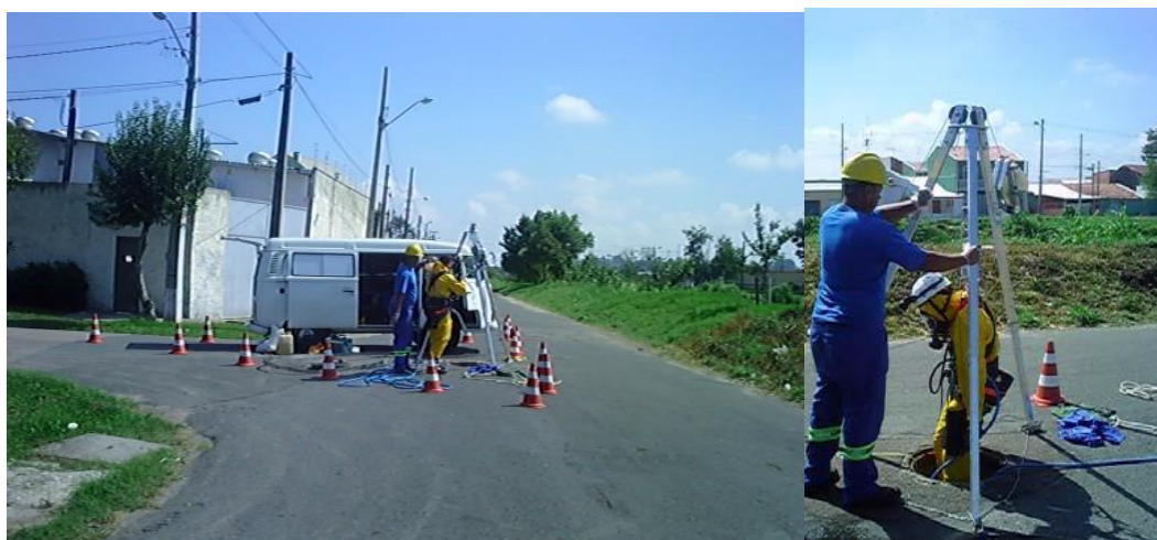
Figura 53 - Fotos de referência externa e procedimento de descida para instalação do medidor de vazão no ponto de controle "P02".
