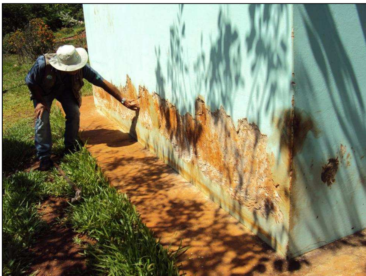
Figura 6 – Danos a estrutura de uma construção em alvenaria, causada pela ação de um grupo de capivaras ( Hydrochoerus hydrochaeris ) no Refúgio Biológico Bela Vista, Foz do Iguaçu, no ano de 2011. Fonte: ITAIPU Binacional.
