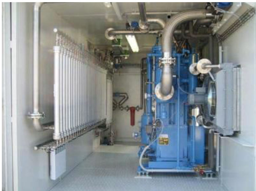
FIGURA 02 – INTERIOR DE UMA PLANTA DE PURIFICAÇÃO DE BIOGÁS POR MEMBRANAS.
