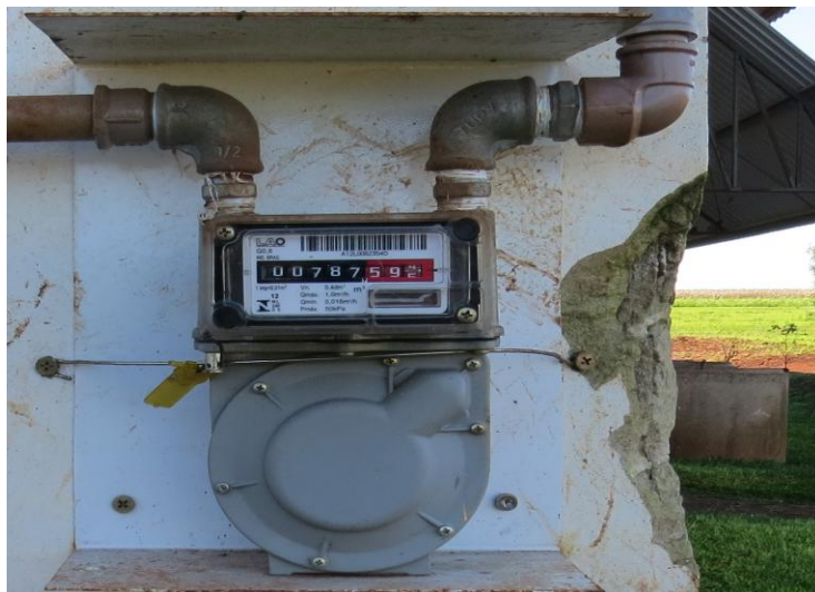
FIGURA 5: Medidor de gás
