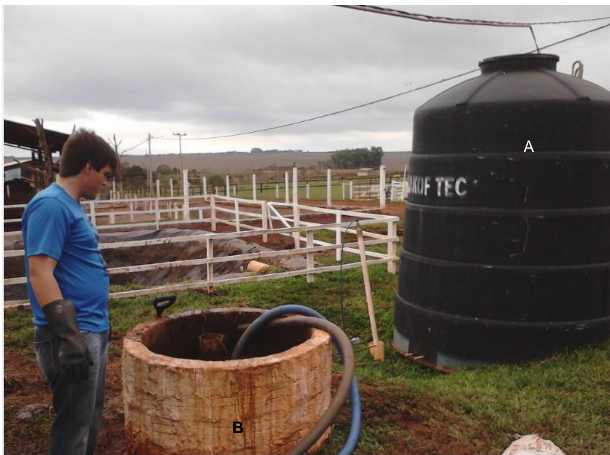
FIGURA 3: (A) Parte superior do biodigestor, (B) Caixa de alimentação
