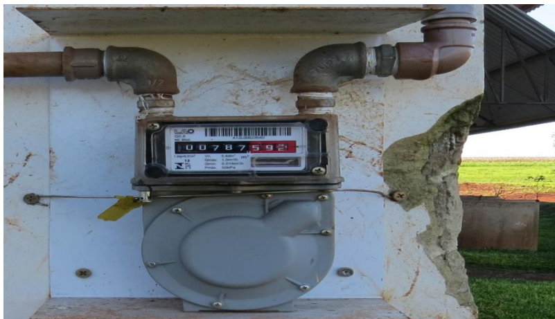
FIGURA 8 - Medidor de gás FONTE: O autor (2013)
