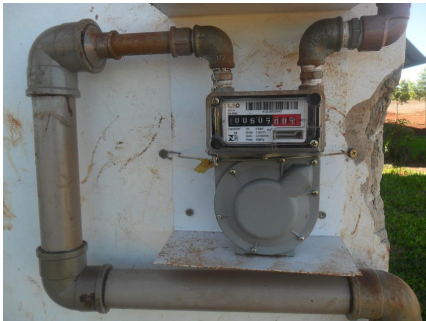
Figura 8 - Medidor de gás. Fonte: UTECH (2013)
