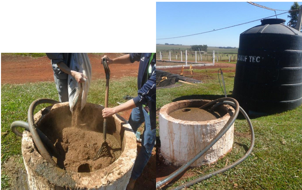
Figura 4 - Adição e homogeneização da cama de aviário na câmara de alimentação, e vista da câmara de alimentação e câmara de biodigestão. Fonte: UTECH (2013)
