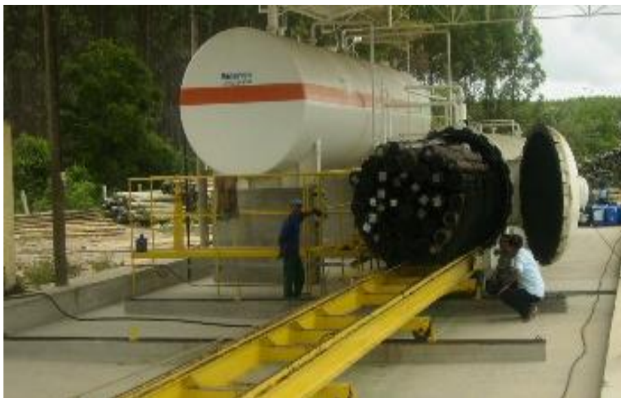
Figura 13 – Usina para Tratamento de Madeira (UTM)
