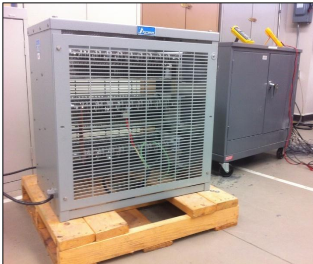
FIGURA 4.2 – BANCO DE RESISTÊNCIAS USADO COMO CARGA FONTE: DILAY et al. (2013)
