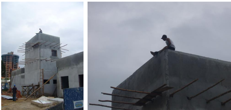
Figura 1 e 2- Operário posicionado acima de 2,00m de altura, sem uso de cinto de segurança, que seria essencial nesta situação, além da falta de uso de outros EPI's obrigatórios.
