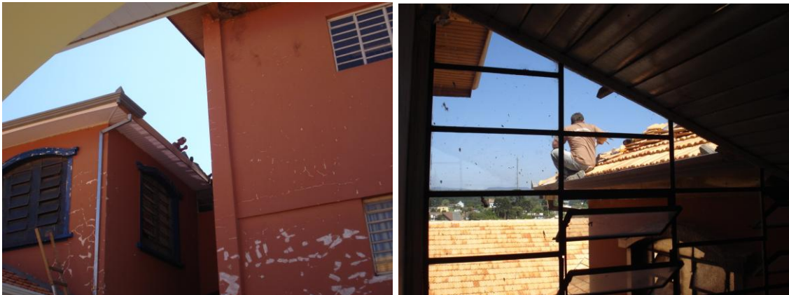
Figura 7e 8- Operários trabalhando numa cobertura acima de 2,00 de altura, sem uso de cinto de segurança, que seria essencial nesta situação, além da falta do uso de outros EPI's obrigatórios.
