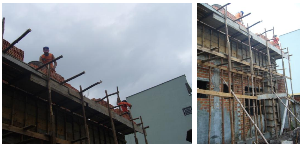
Figura 3 e 4- Operários posicionados acima de 2,00m de altura, sem uso de cinto de segurança, que seria essencial nesta situação, além da falta do uso de outros EPI's obrigatórios.
