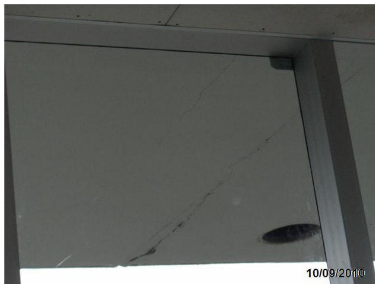
Figura 32: Fissuração na direção do balanço da marquise. Fonte: Registro fotográfico.
