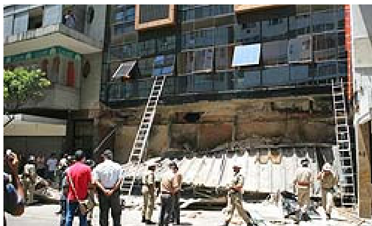
Figura 3: Desabamento de marquise de um hotel em 26/02/07, em Copacabana-RJ deixou feridos e duas vítimas fatais.
