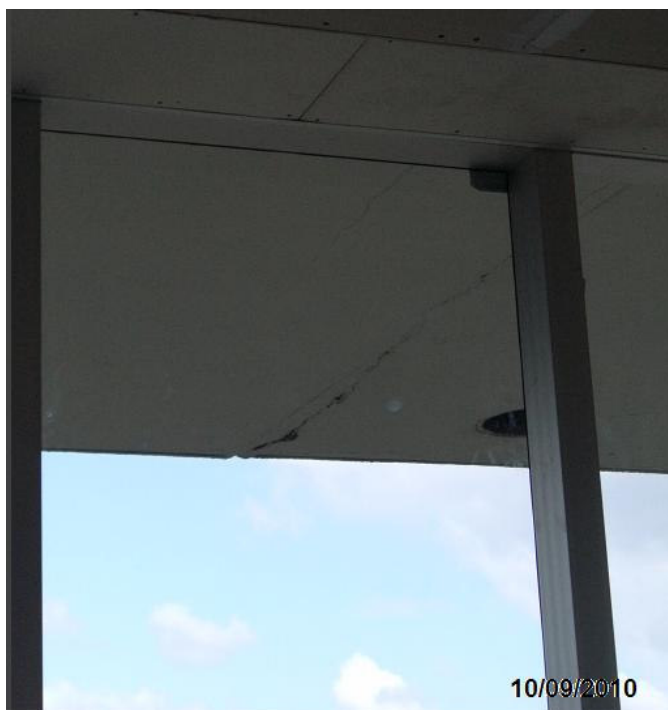
Figura 31: Presença de fissuras e trincas.
