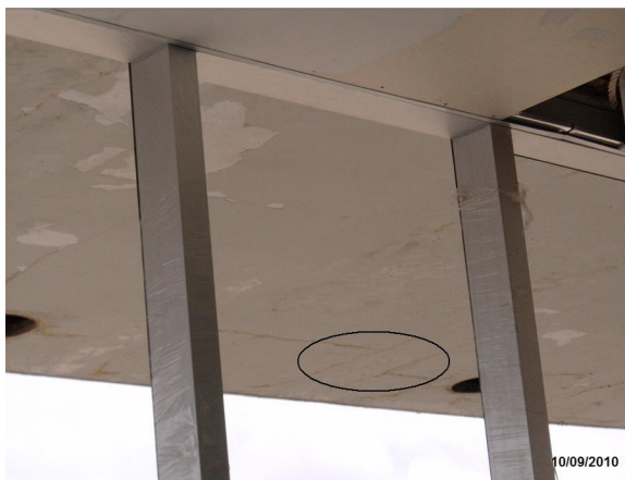
Figura 35: Fissuras. Fonte: Registro fotográfico.
