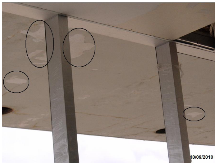
Figura 38: Pontos de esfoliação da pintura. Fonte: Registro fotográfico.
