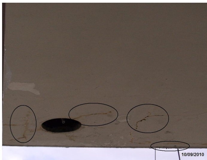
Figura 37: Evidência de quadro patológico avançado referente à corrosão da armadura.
