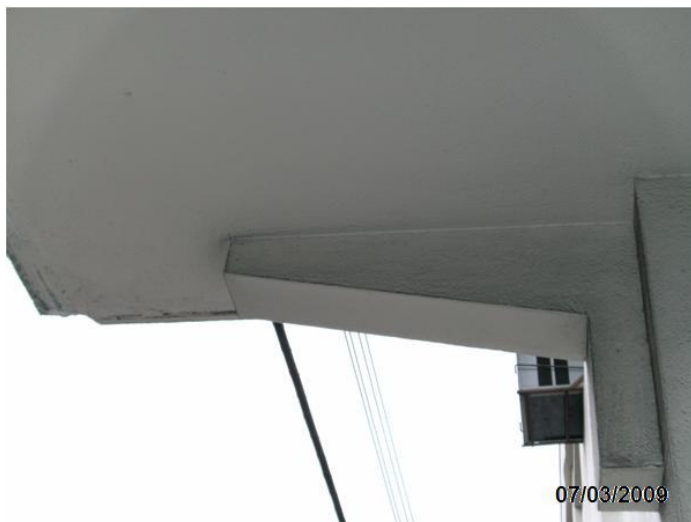
Figura 24: Consolo lado esquerdo – parte interna, sem presença de fissuras. Fonte: Registro fotográfico.
