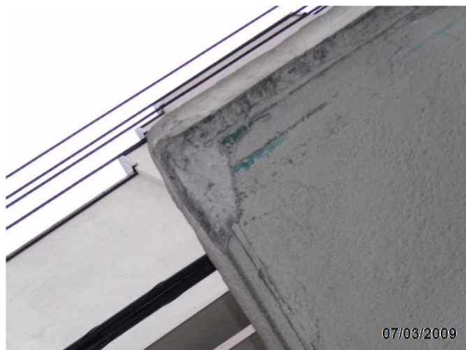
Figura 22: Desprendimento do concreto e ausência de pingadeira Fonte: Registro fotográfico.
