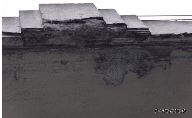
Figura 20: Desprendimento do revestimento do concreto Fonte: Registro fotográfico.
