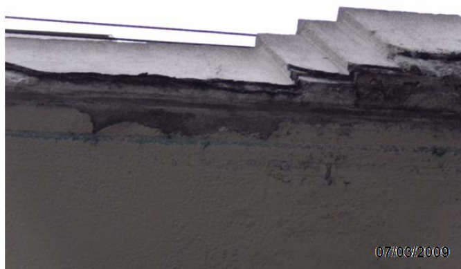
Figura 21: Deterioração causada pela raspagem de caminhões. Fonte: Registro fotográfico.
