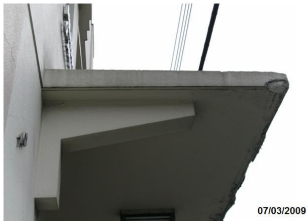
Figura 23: Consolo lado esquerdo – parte externa, sem presença de fissuras. Fonte: Registro fotográfico.
