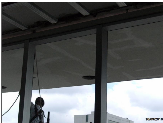
Figura 42: Recuperação paliativa da marquise, com massa acrílica e pintura. Fonte: Registro fotográfico.
