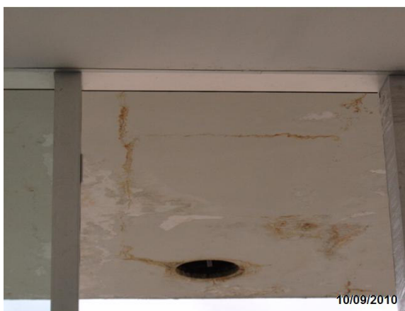
Figura 34: Manchas de tonalidade marron-avermelhada característica de corrosão interna da armadura.
