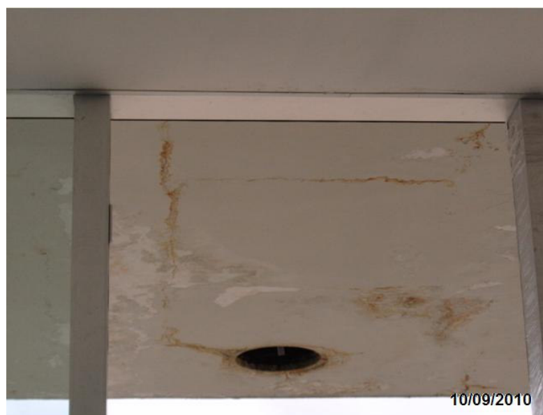
Figura 33: Manchas de infiltração de água, com evidência de corrosão generalizada. Fonte: Registro fotográfico.
