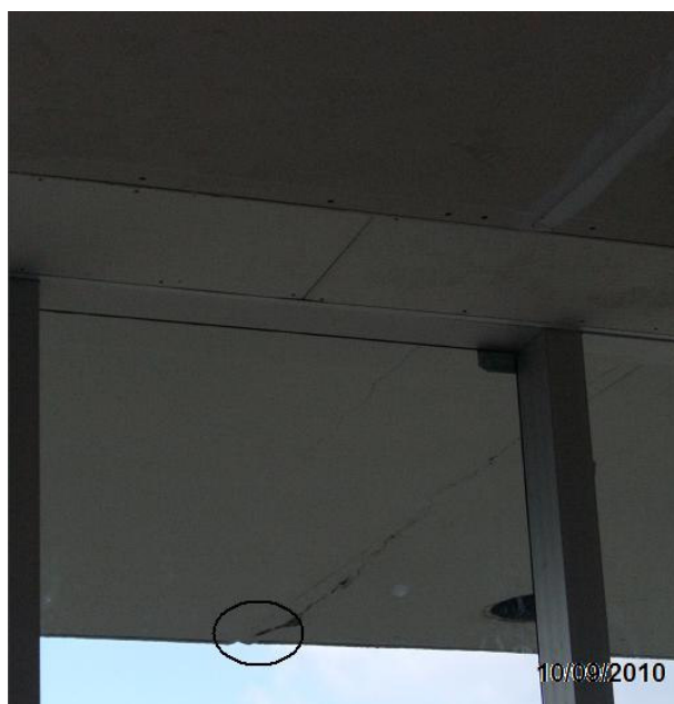
Figura 39: desprendimento da borda da pingadeira e abertura de trincas. Fonte: Registro fotográfico.
