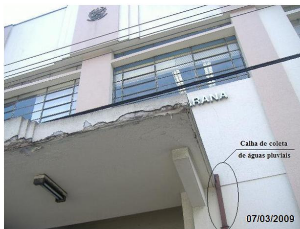
Figura 27: Sistema condutor de água pluvial. Fonte: Registro fotográfico.
