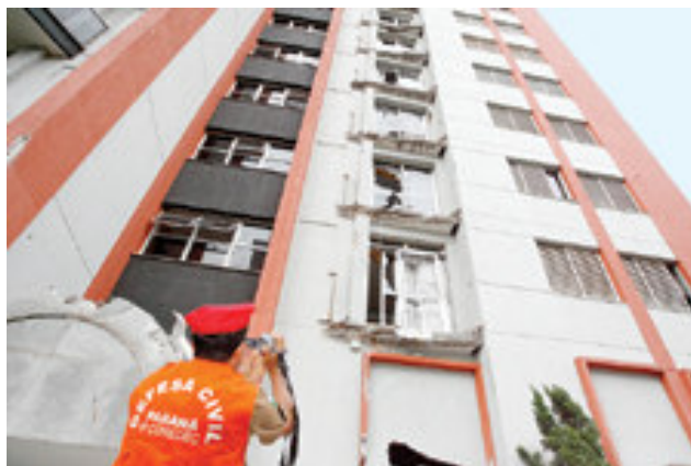
Figura 1: Desabamento da sacada do 15º andar com a destruição das demais sacadas em 26/10/08 em Maringá-PR.
