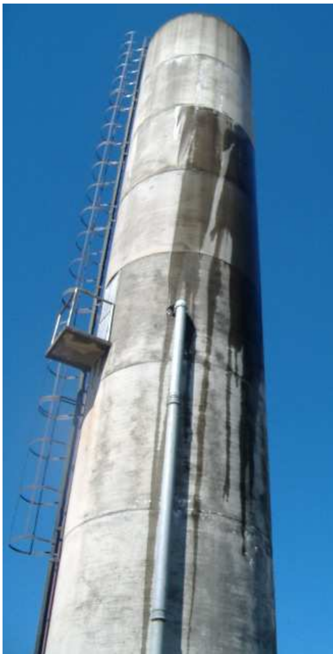
Figura 15 – Foto de um reservatório de água potável de uma obra do Estado com problemas de infiltração relacionados ao concreto
