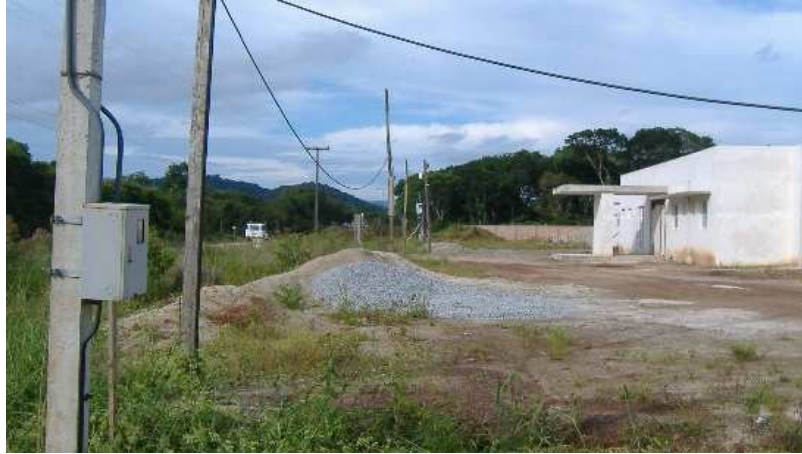
Figura 07 - Armazenamento inadequado de agregados graúdo e miúdo em uma obra do litoral do Estado do Paraná.
