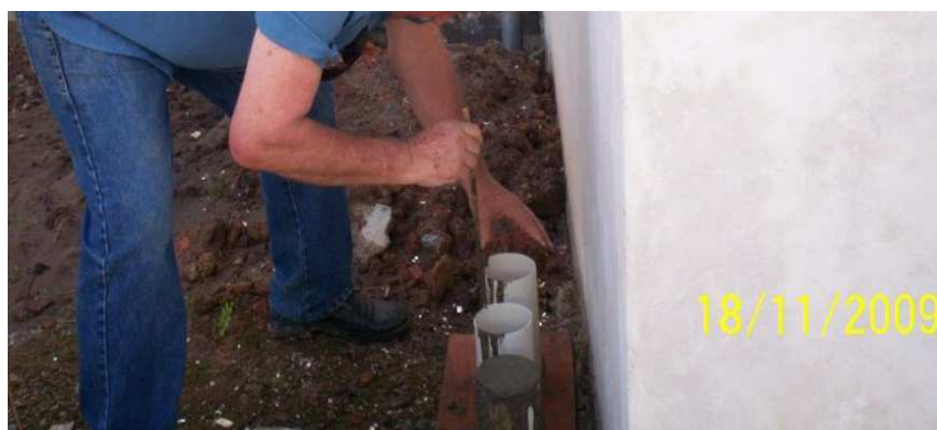
Figura 10 – Imagem da fiscalização de uma obra no litoral do Estado, recolhimento de corpos-de-prova em estado fresco em tubos de PVC de 100mm recortados, improvisando moldes de corpos-de-prova.
