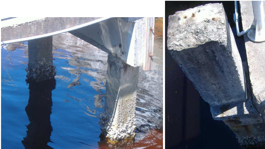
Figuras 01 e 02 – Pilares de concreto armado, que servem de sustentação de embarcadouro no litoral do estado, ambiente de agressividade ambiental muito forte.
