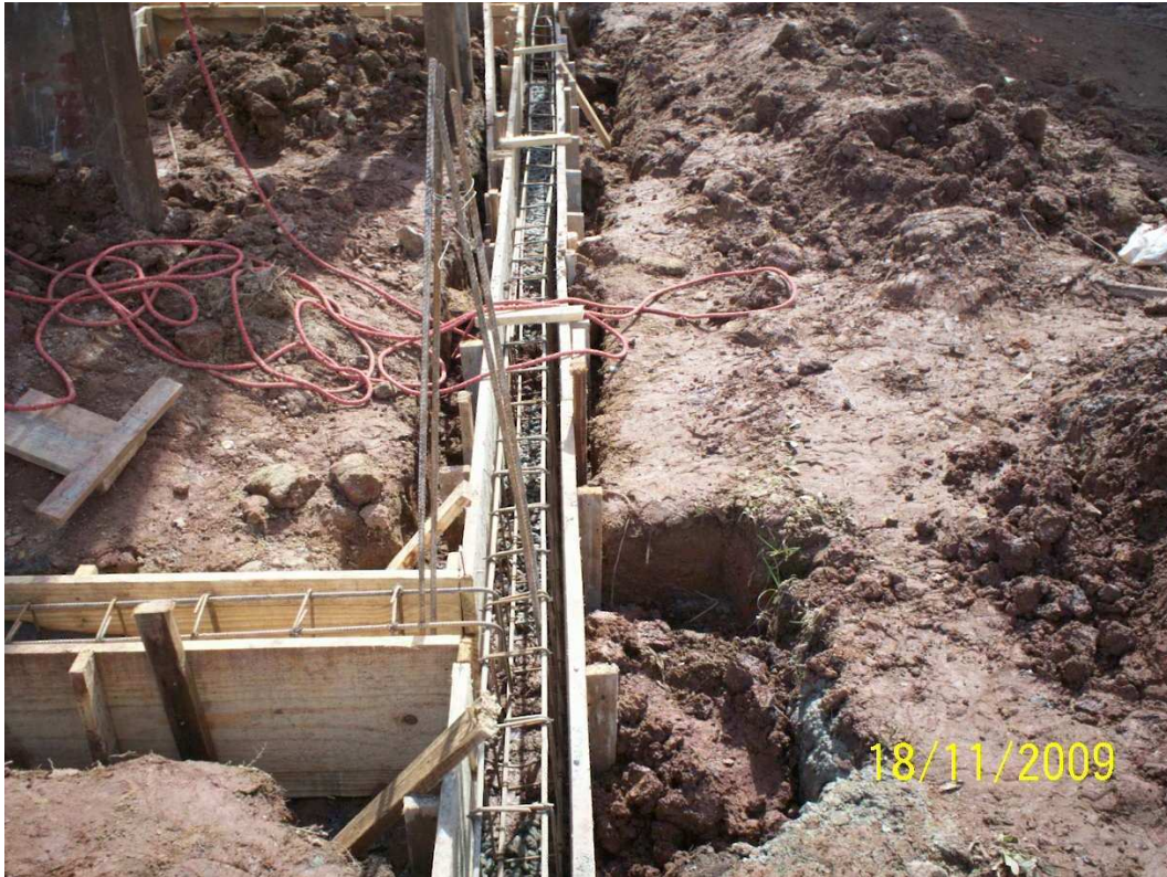
Figura 19 – Forma e armaduras de viga de baldrame apresentando desalinhamento em obra do Hospital Wallace Thadeu de Mello e Silva em Guaraqueçaba-PR.
