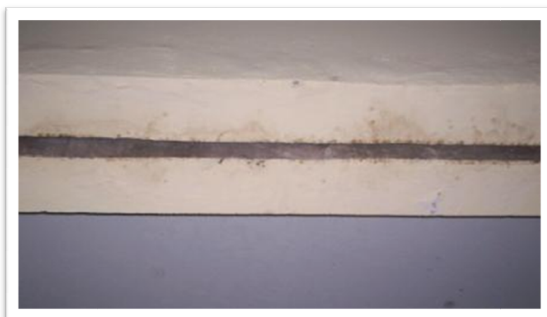
Figura 20 - vista de junta entre vigas com indícios de infiltrações
