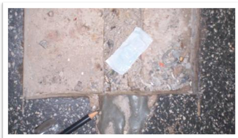
Figura 18 - material encontrado, no interior da junta, abaixo da vedação - concreto
