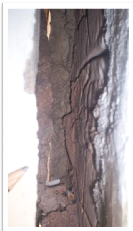
Figura 22 - interior de junta sem fechamento e com detritos no interior
