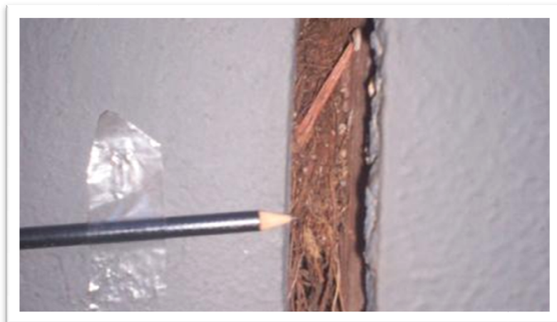
Figura 23 - detalhe de junta com detritos do interior e sem vedação
