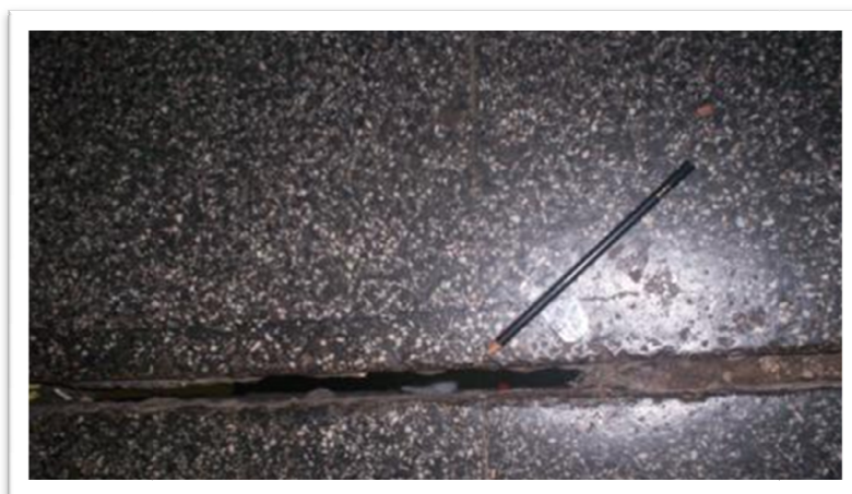
Figura 17 - detalhe de falha na vedação
