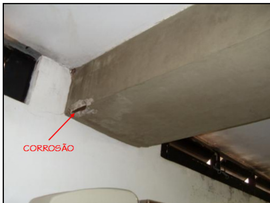
Figura 15 - Laboratório de Química / Física (3) Fonte: Elaborado pelo autor, 2010
