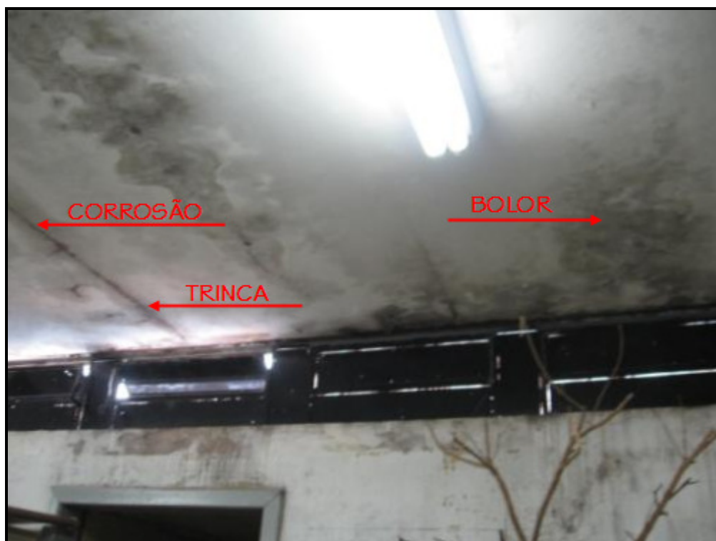
Figura 11 - Laboratório de Química / Física (1) Fonte: Elaborado pelo autor, 2010
