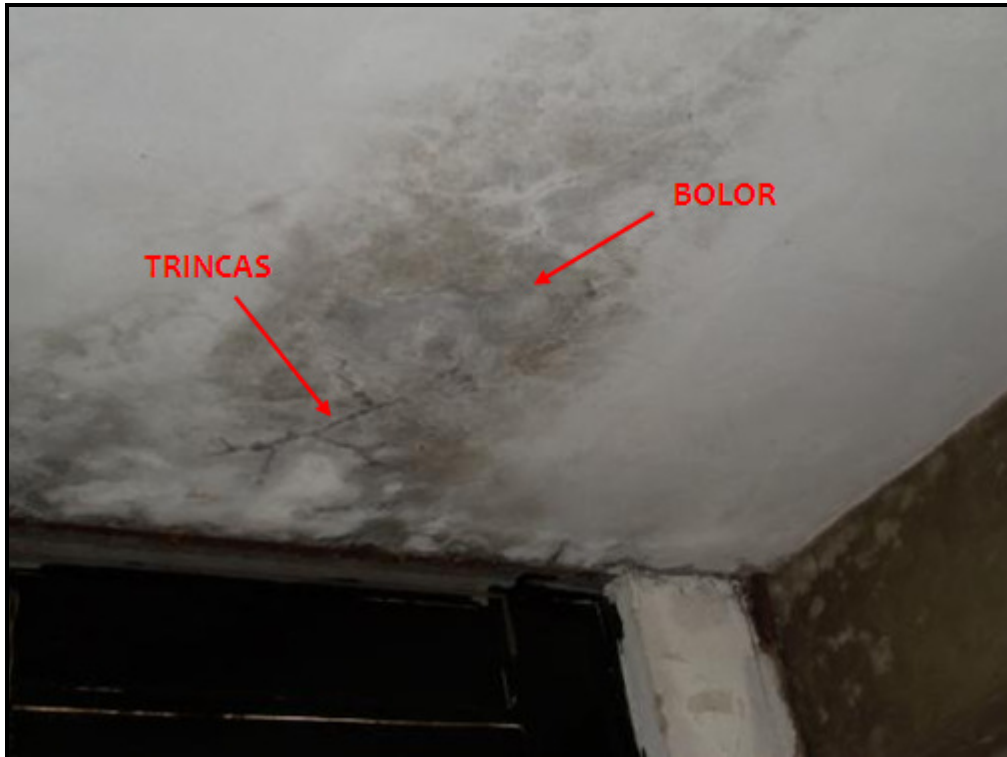
Figura 12 - Laboratório de Química / Física (2) Fonte: Elaborado pelo autor, 2010
