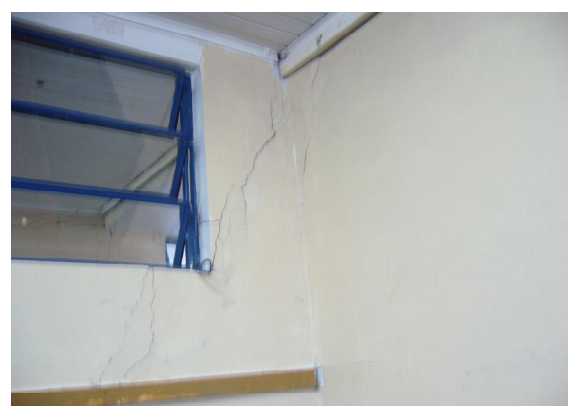
Figura 49: Rachaduras nas paredes das salas de aula
