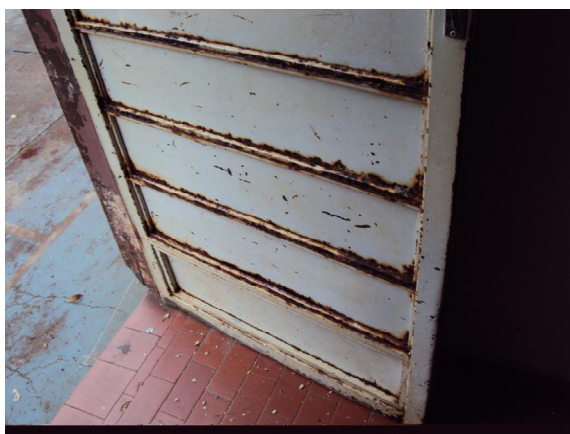
Figura 36: Porta metálica oxidada
