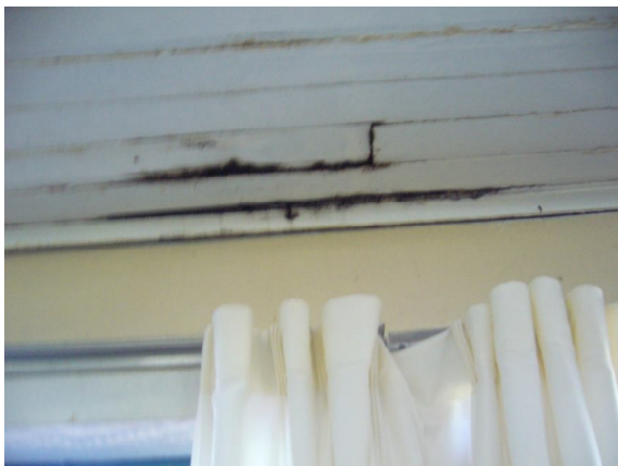
Figura 50: Forros em madeira apodrecidos
