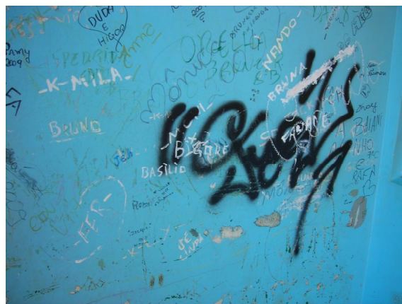
Figura 27: Paredes com pichações
