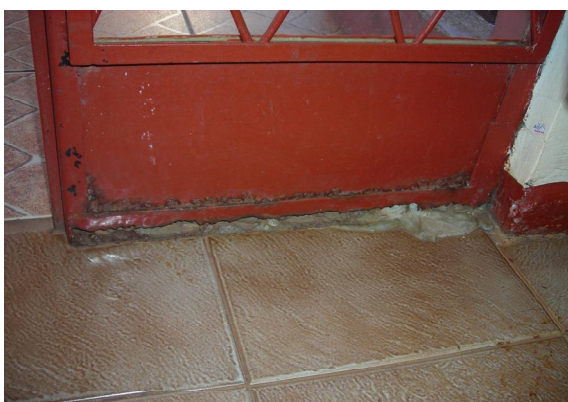
Figura 59: Porta metálica - circulação
