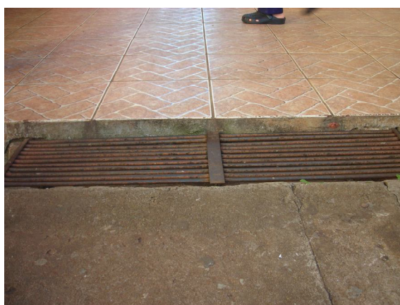
Figura 49: Grelha na base da rampa do pátio
