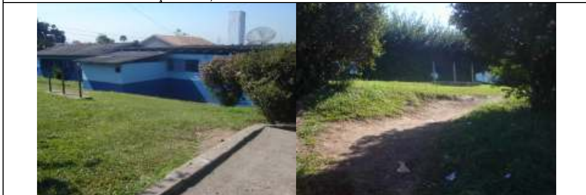
FOTOS 04 e 05 – Executar rampa de acesso em concreto e guarda-corpo padrão SUDE. Rampa com 8,33% de inclinação e comprimento total de 46,48 metros.
