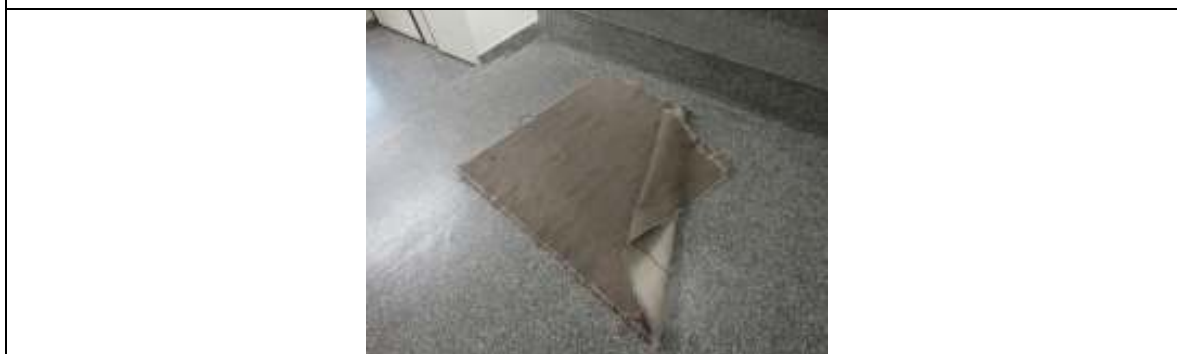
Fotos 46, 47 e 48 – Circulação vertical, escada de concreto, revestida com granitina, sem corrimãos e com um capacho “embolado”, tornando-se um obstáculo.
