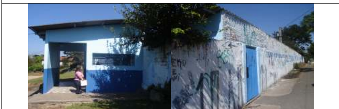
FOTOS 09 e 10_– Substituição de telhado e execução de toldo removível no acesso principal a escola.
