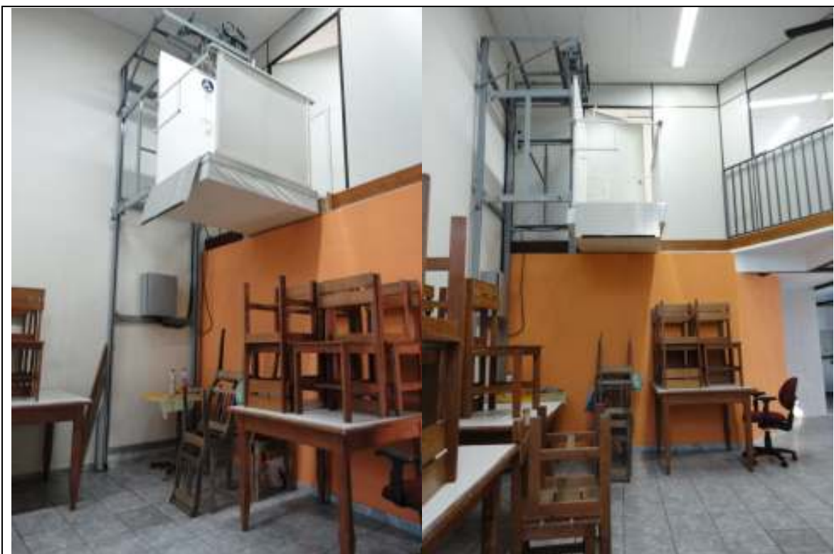
Fotos 51 e 52 – Plataforma elevatória vertical para vencer o desnível de 2,70m. Não condiz com a NBR 15.665-1.
