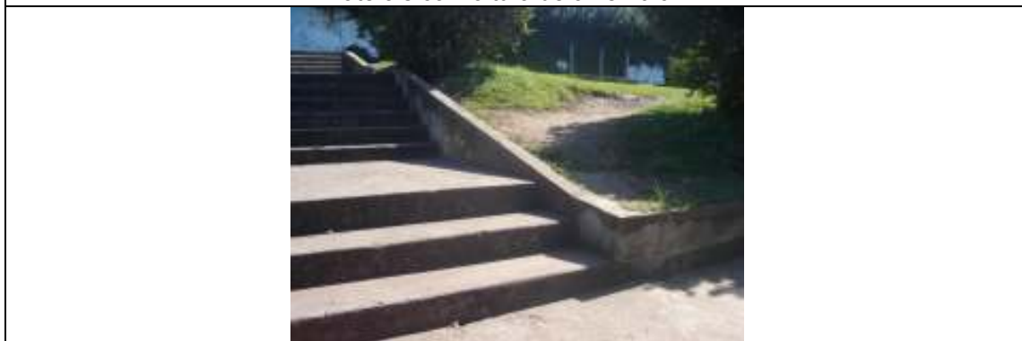
Foto 03 – Acesso principal – Escadaria – Local onde deverá ser executada rampa – com inclinação de 8,33% e corrimãos com altura de 92 e 70cm.
