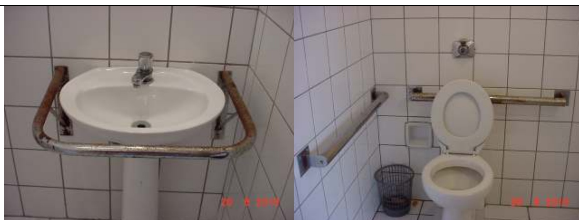
Fotos 12 e 13 – Lavatório de coluna que dificulta a aproximação da cadeira de rodas , torneira mono-comando redonda que é contrária a norma e barras de apoio apresentando ferrugem.
