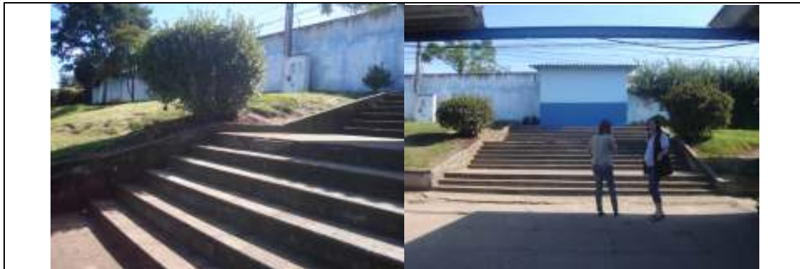
FOTOS 01 e 02 – Acesso Principal de Alunos – Escadaria – Prever corrimãos central e laterais com altura de 92 e 70 cm.
