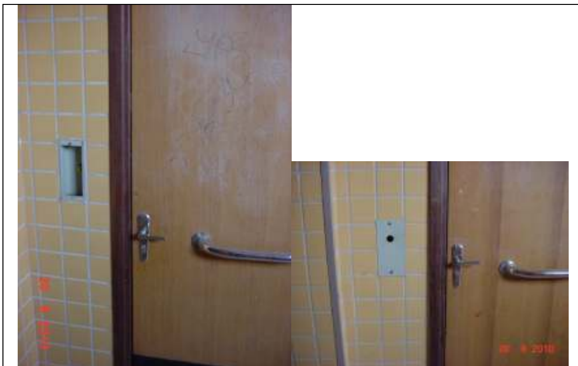
Fotos 14 e 15 – Elevadores inexistentes conforme relato da secretária da escola
