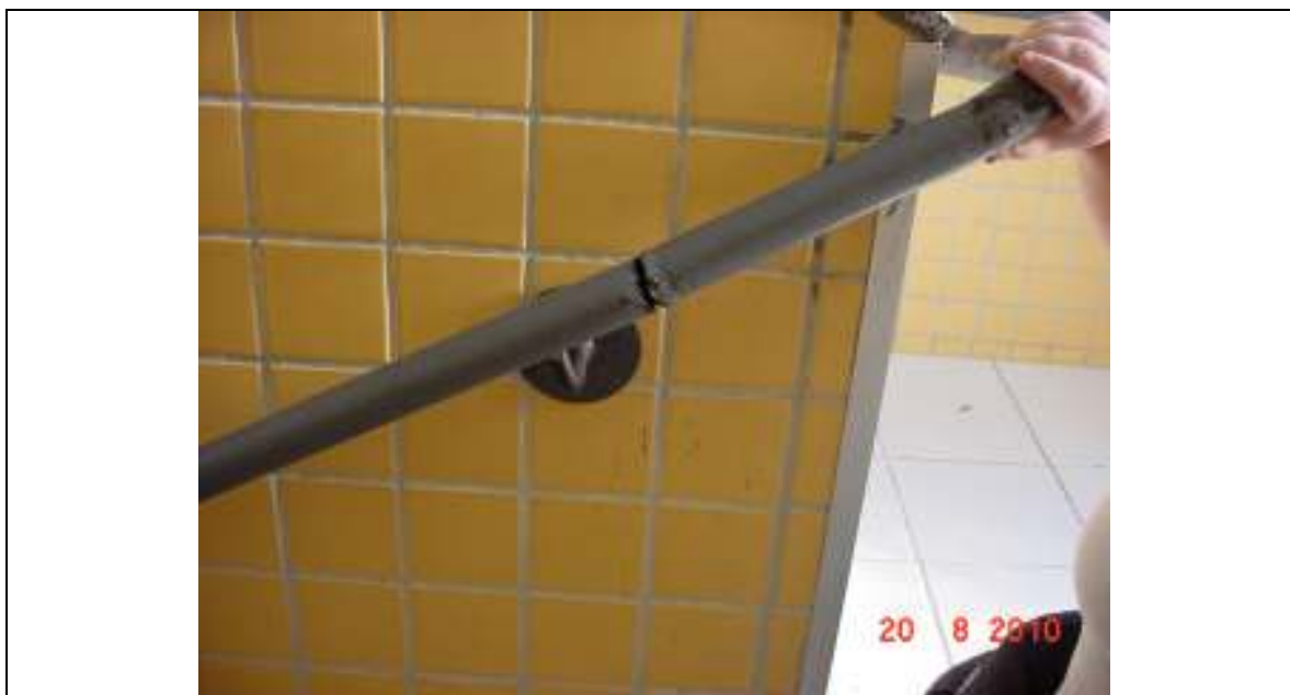
Foto 11 – Detalhe do corrimão da escada. Apresentando ferrugem e com solda desgastada, tornando-o solto e inseguro.
