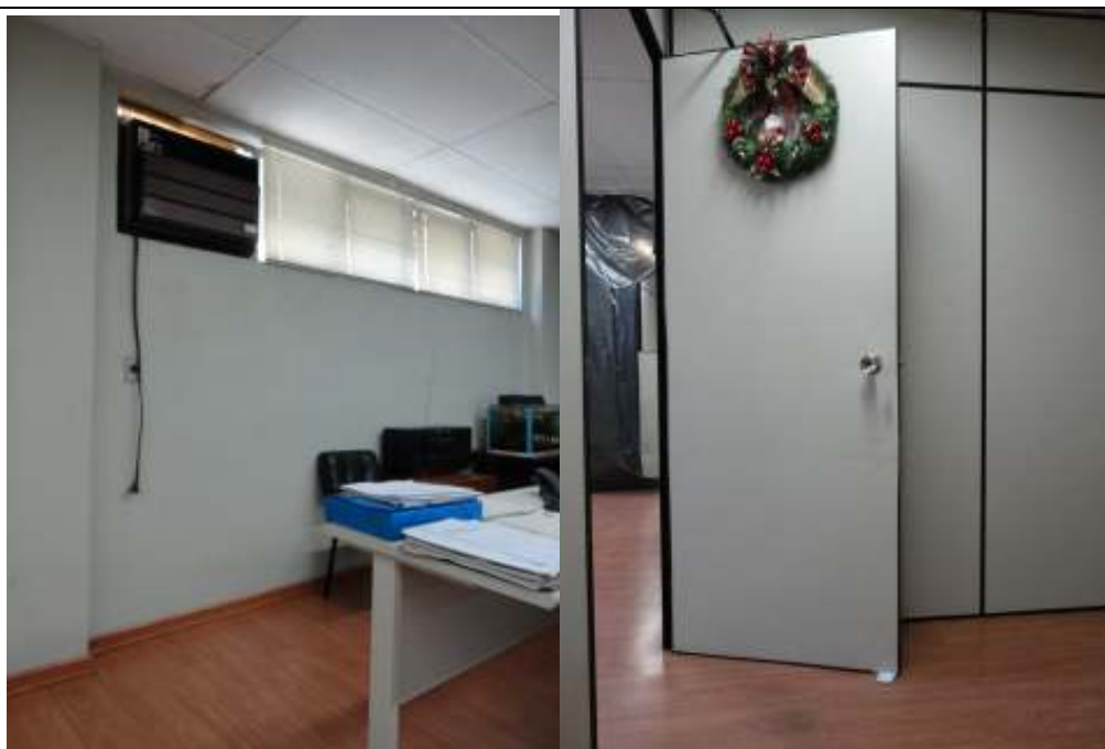
Fotos 53 e 54 – Janelas localizadas acima de 1,40m de altura do chão e portas com fechaduras tipo “bola” diferente da recomendação pela NBR 9050:2004 tipo alavanca, que necessita de um movimento apenas.
