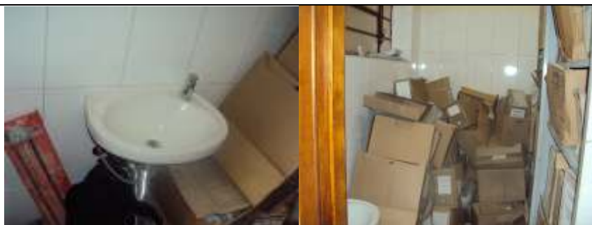
Fotos 40 e 41 – Instalação Sanitária para Pessoas com Deficiência em agosto de 2.010. Ainda faltava instalar barra de apoio no lavatório, enquanto que o resto do ambiente servia de depósito para caixas de arquivo.
