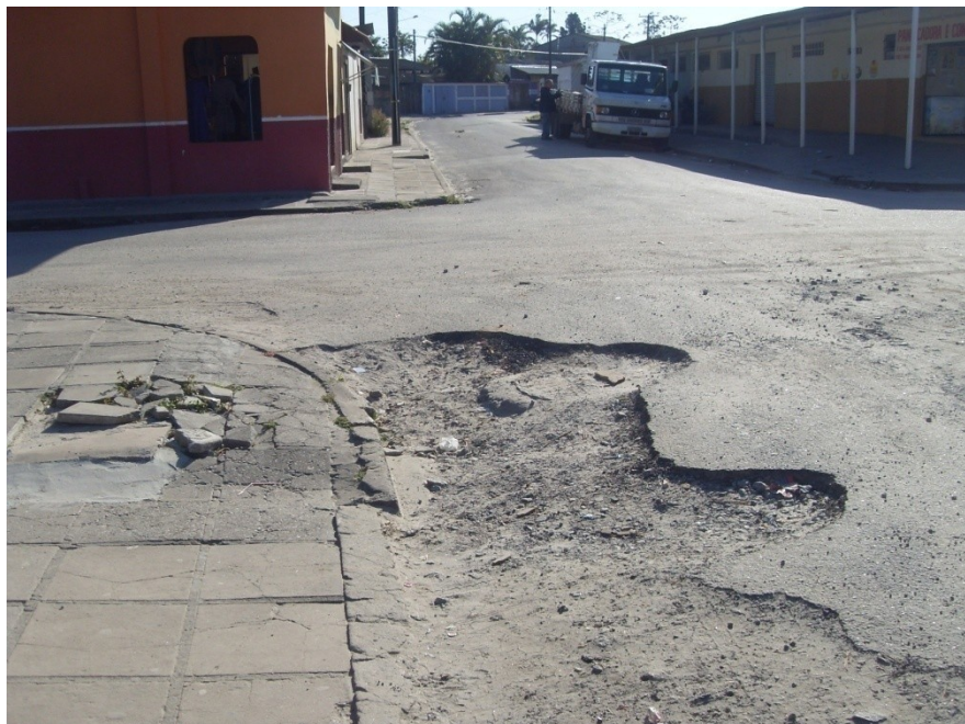
Figura 4 – Buraco na esquina da Rua Jatobás
