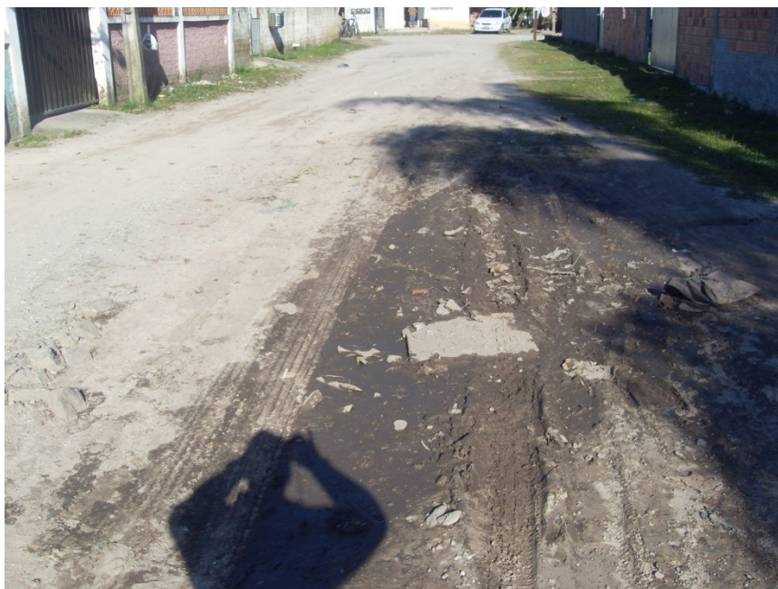
Figura 3 – Buraco causado pelo caminhão da figura 2
