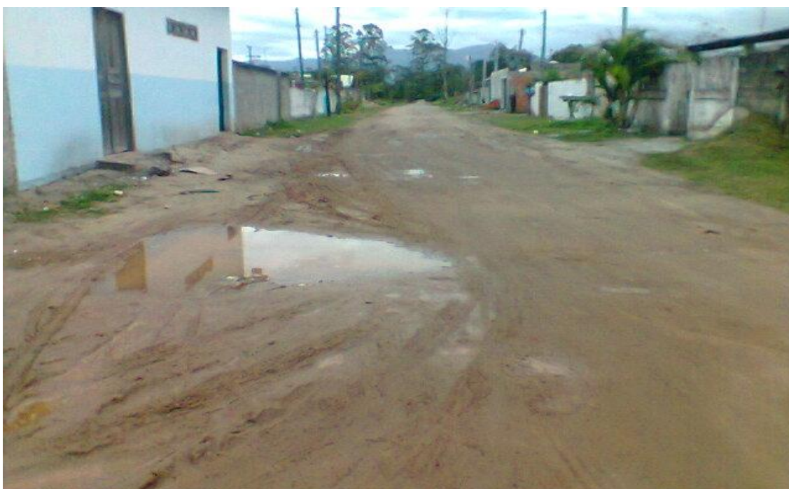
Imagem 4. Ausência de rede coletora de águas pluviais e esgoto doméstico.
