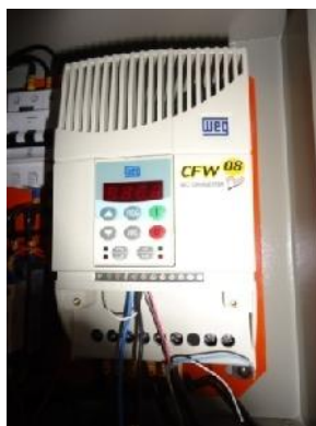
Figura 3.9 - Inversor de frequência.
