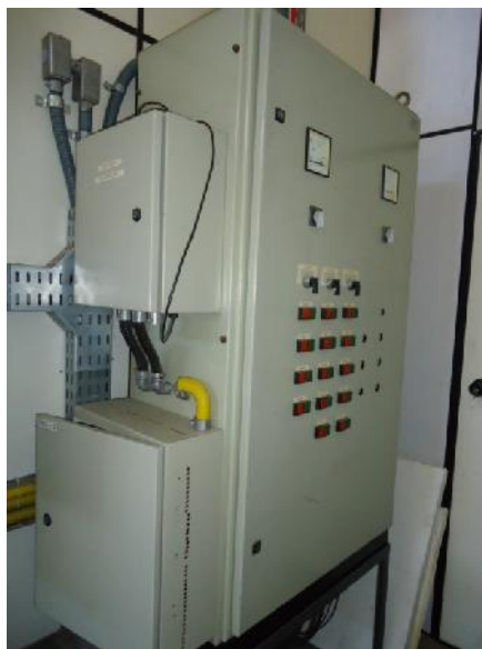
Figura 3.11 - Quadro de comando.
