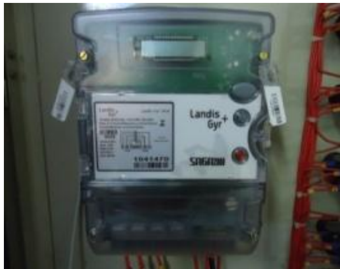
Figura 3.13 - Medidor de energia.
