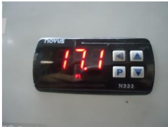
Figura 3.16 - Termostato N322 com saída Modbus.
