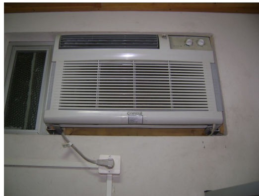
Figura 14: Ar condicionado Fonte: Própria
