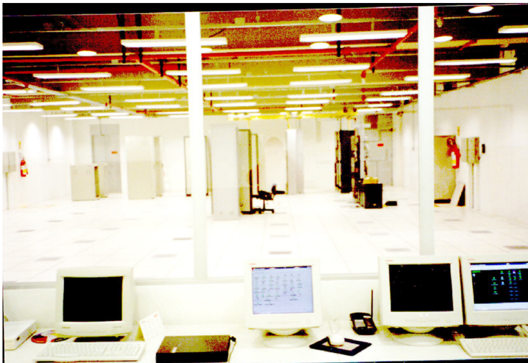
Figura 35 - Sala de hospedagem de equipamentos da IMPSAT
