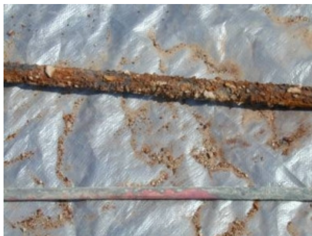
Figura 1.5 – Corrosão instalada em eletrodo de aterramento de cobre retirado do solo. (Adaptado de MORENO e COSTA, 2011)
