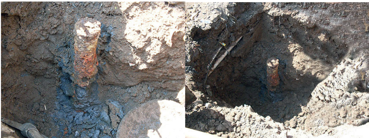
Figura 1.3 – Eletrodos de aterramento em cobre corroídos.
