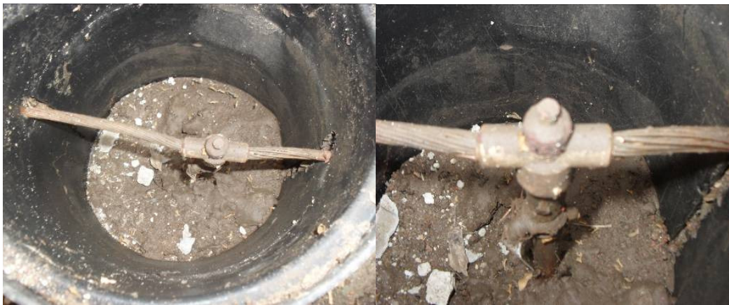
Figura 1.4 – Eletrodos de aterramento do tipo Cooperweld, conectados entre si formando uma malha de aterramento.
