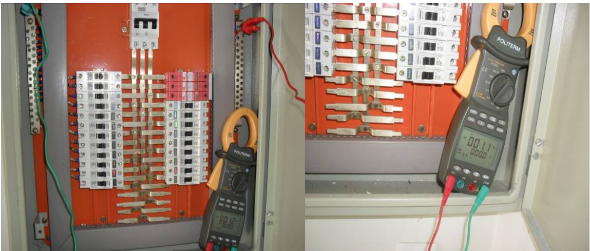
Figura 1.1 – Diferença de potencial em um sistema de aterramento que deveria apresentar equipotencialização.
