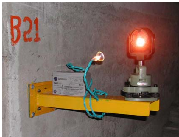
FIGURA 44 - DCF COM PRISMA INSTALADO
