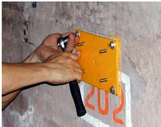
FIGURA 29 - CHAPAS DE FIXAÇÃO DOS DCF
