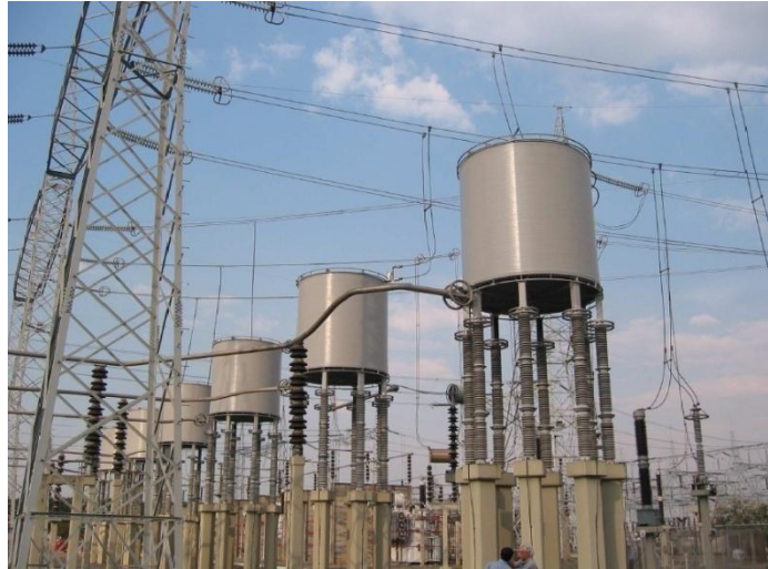
Figura 2.9 - RLC na subestação Mogi das Cruzes 345 kV Fonte: (D'AJUZ, 2007)
