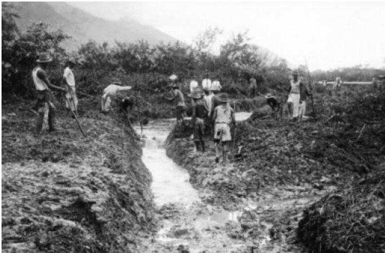
FOTOGRAFIA 1- OBRAS DE ENGENHARIA SANITÁRIA NO RIO DE JANEIRO FONTE: Arquivo Belisário Penna, Casa de Oswaldo Cruz/FIOCRUZ (1918-1932)
