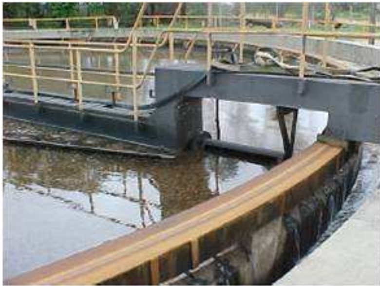
Figura 2.2: Decantadores Secundários - REPAR.
