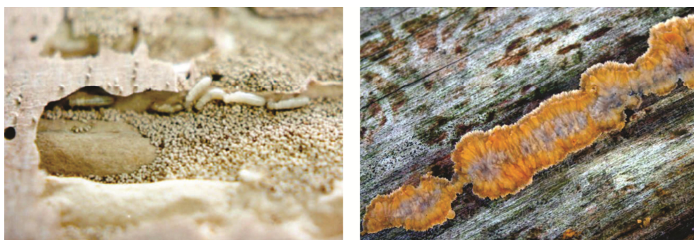
FIGURA 3 - DANOS PROVOCADOS POR FATORES BIOLÓGICOS: CUPINS E FUNGOS
