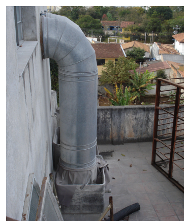
FIGURA 17 - TUBULAÇÃO DE SAÍDA DOS RESÍDUOS
