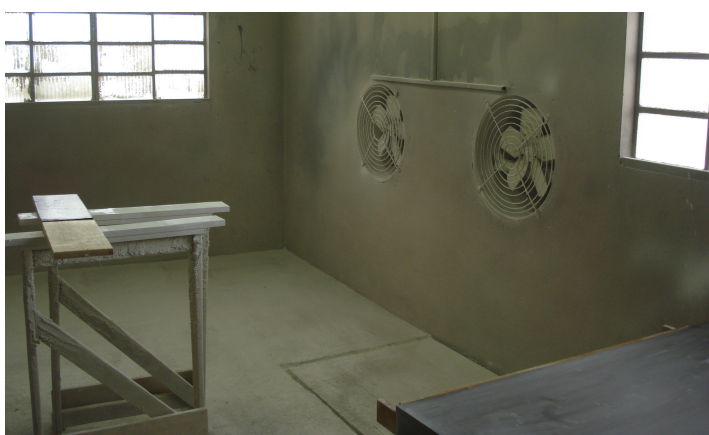
FIGURA 18 - EXAUSTORES EM SALA DE PINTURA DE MÓVEIS E PAINÉIS
