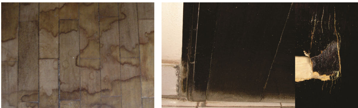
FIGURA 2 - DANOS PROVOCADOS POR FATORES NÃO BIOLÓGICOS: UMIDADE, ATAQUES QUÍMICOS E MECÂNICOS
