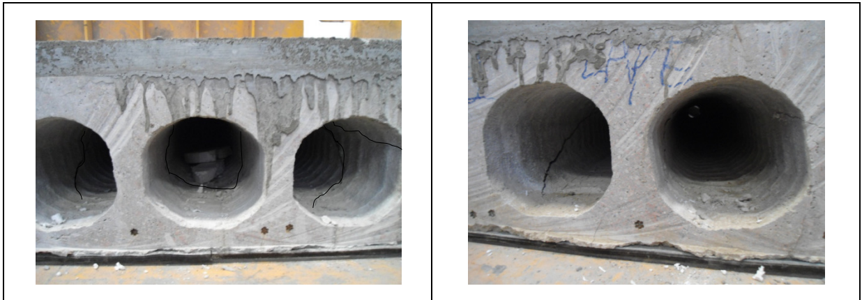
FIGURA 39– FISSURAS NAS NERVURAS DA PRIMEIRA e SEGUNDA LA001-B. FONTE: A autora (2012).
