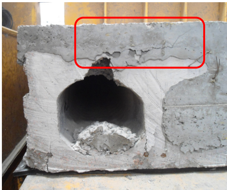
FIGURA 42 - FISSURA NA INTERFACE ENTRE O CONCRETO DA CAPA E O CONCRETO DA LAJE PRÉ-FABRICADA E FISSURAS JUNTO ÀS CORDOALHAS DA PRIMEIRA LA003-B. FONTE: A autora (2012).
