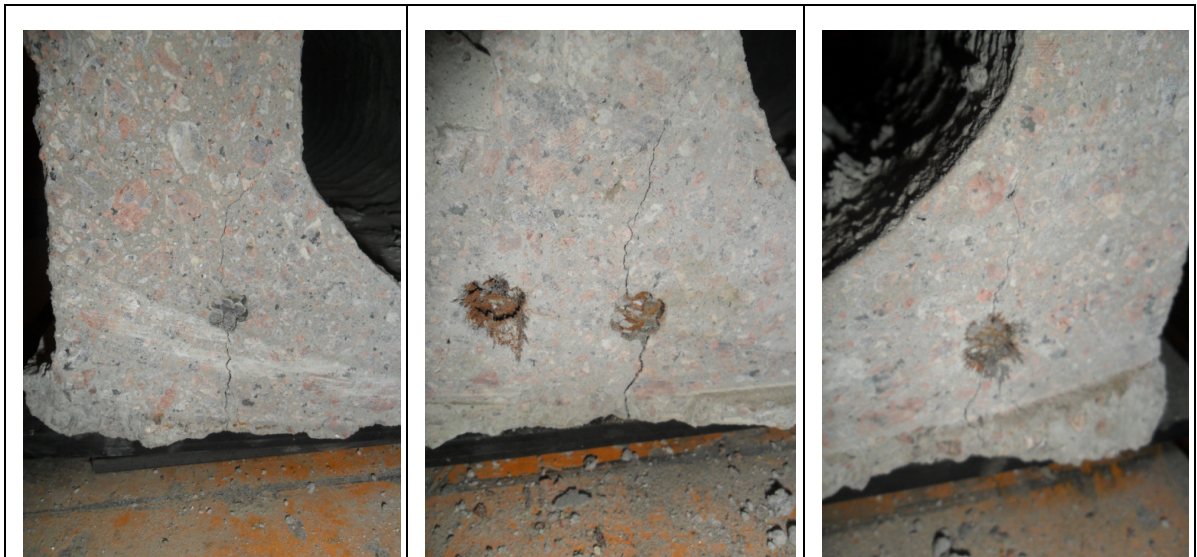
FIGURA 36 – DETALHE DAS FISSURAS JUNTO ÀS CORDOALHAS DA SEGUNDA LA003-A. FONTE: A autora (2012).
