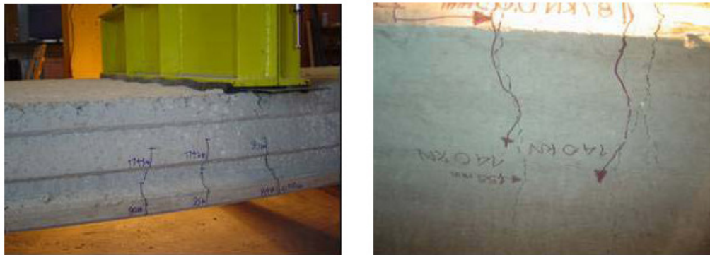
FIGURA 20 – PANORAMA FISSURADO DE UMA LAJE ALVEOLAR APÓS ENSAIO DE FLEXÃO. FONTE: COSTA (2009).
