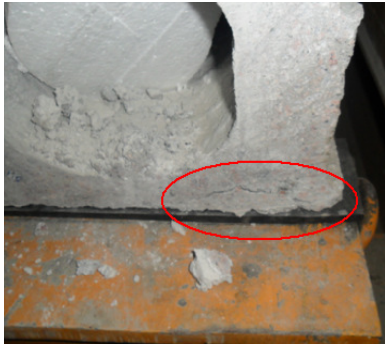
FIGURA 31 – LA001-A - DESPLACAMENTO DO CONCRETO PRÓXIMO À CORDOALHA (FALHA DE ANCORAGEM).
