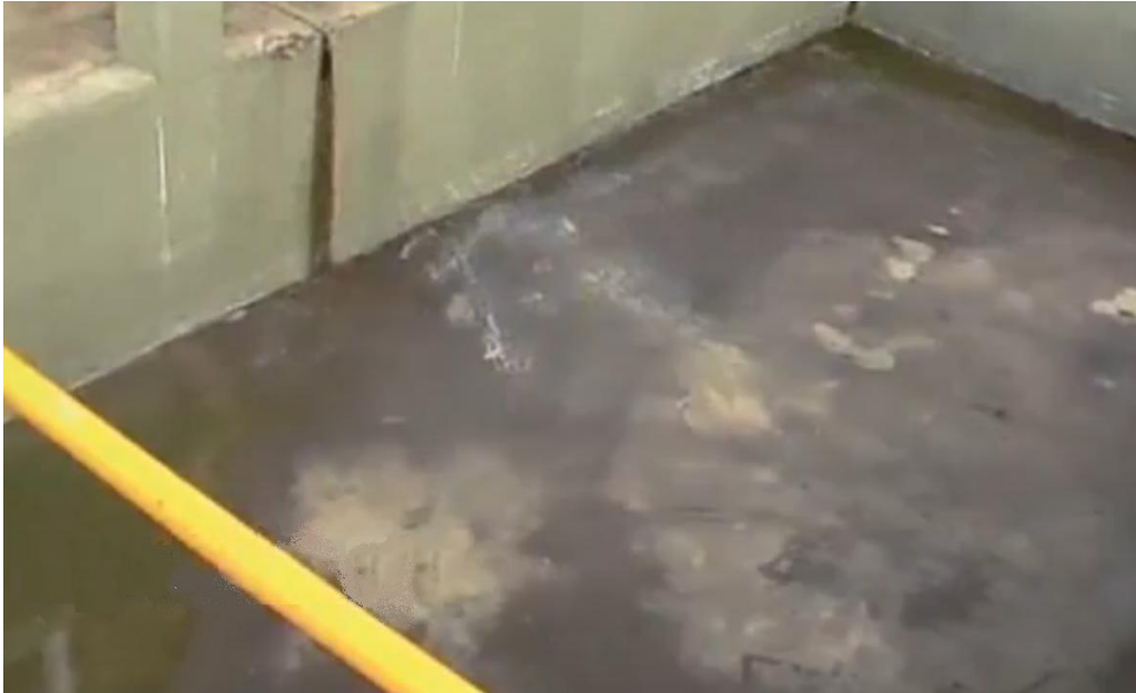
FIGURA 21 – BACIA DE CONTENÇÃO
