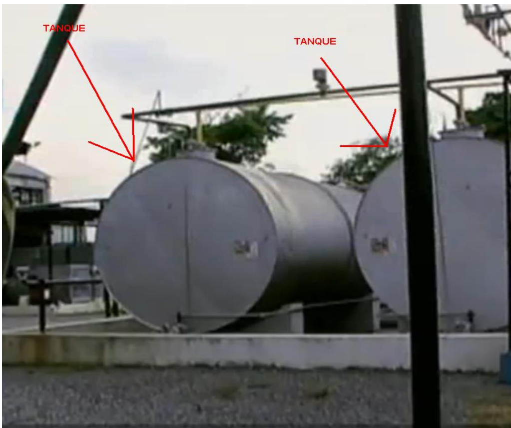
FIGURA 22 – TANQUE DE ARMAZENAMENTO
