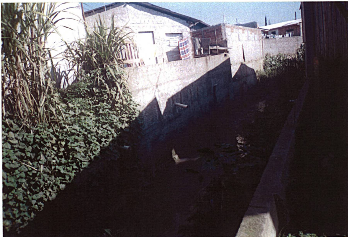
FOTO Nº 11 – OCUPAÇÃO IRREGULAR PARANÁ (CAPÃO RASO) – DESPEJO DE ESGOTO VIA RIO.
