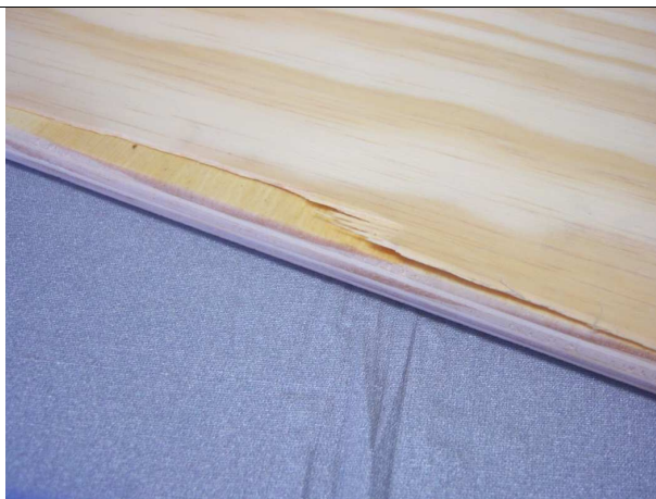
Desagregação do compensado por ação do vapor
