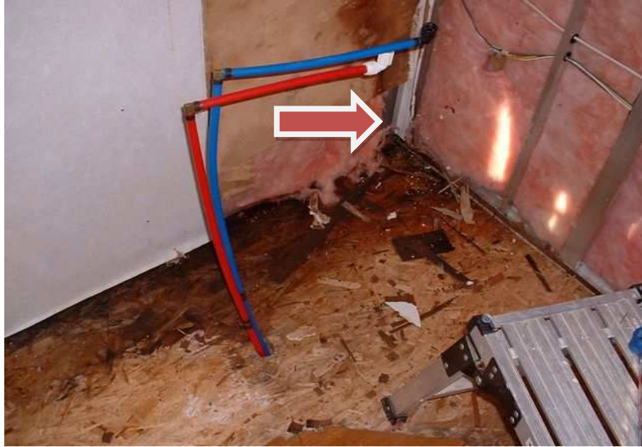
Figura 30: Danos sob a pia. Fonte: Nightrider (2010)
