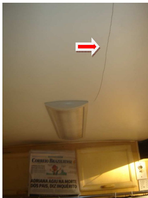
Figura 6: Rachadura em teto de motorhome.
