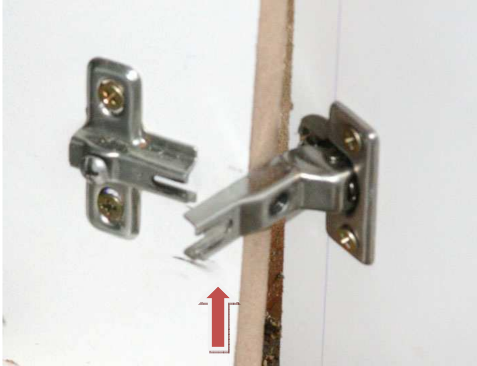
Figura 103: Colapso da dobradiça e riscos no acabamento (CP1)
