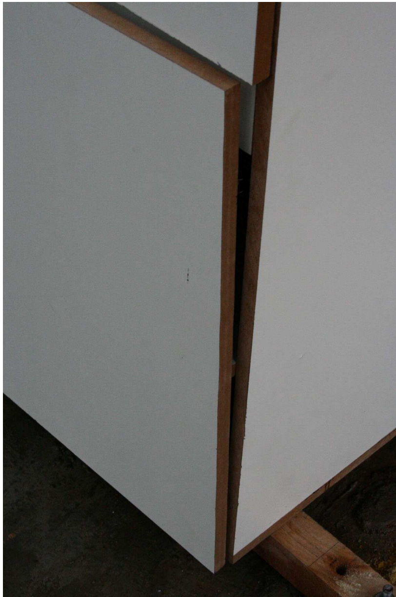
Figura 102: Colapso da dobradiça
