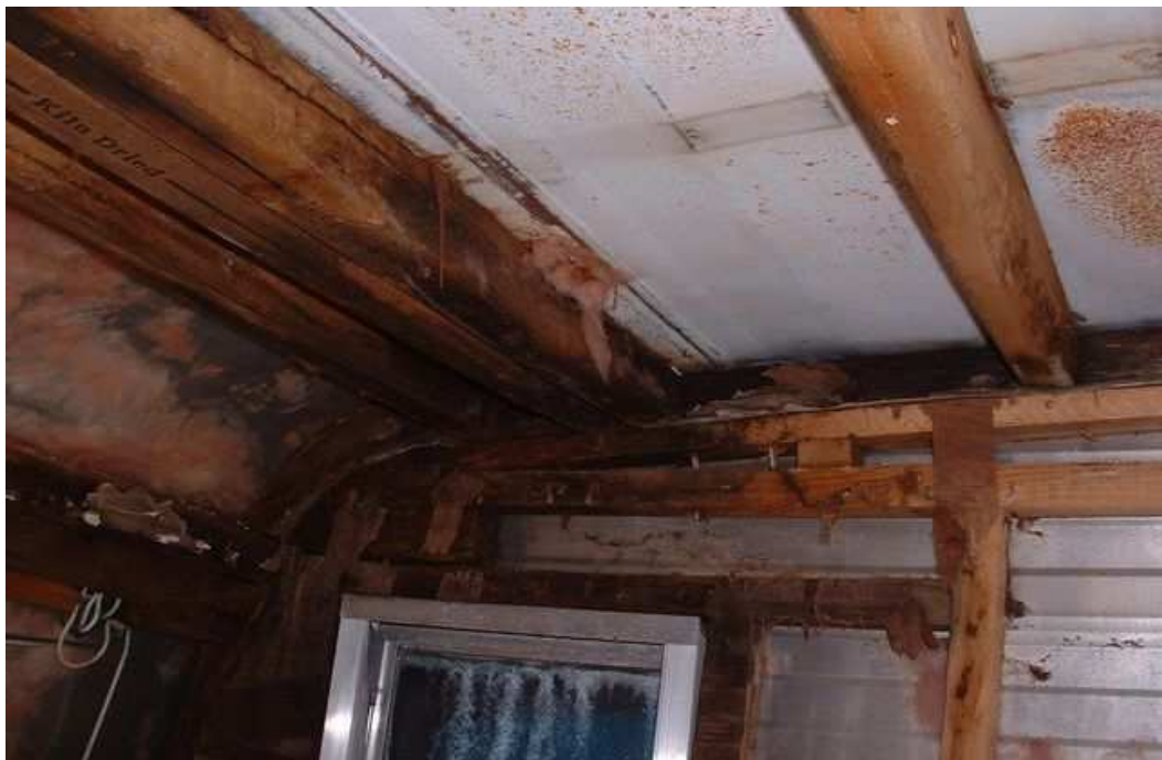
Figura 31: Infiltração de chuva no teto de um trailer convencional. Fonte: Nightrider (2010)
