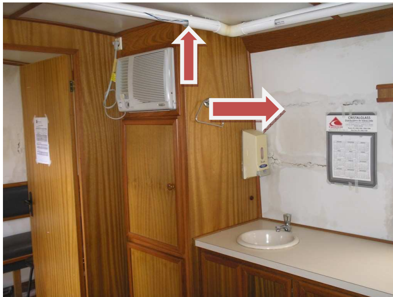
Figura 25: Rachaduras e luminárias tortas. Fonte: Freire (2008)
