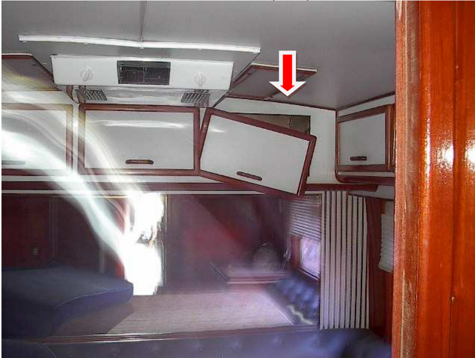
Figura 59: Portas danificadas Fonte: Matheus (2011)
