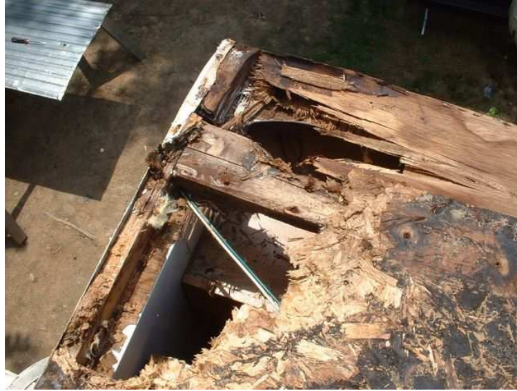
Figura 32: Apodrecimento da estrutura do teto de um trailer. Fonte: Nightrider (2010)
