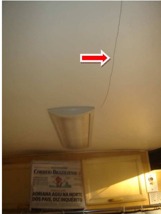
Figura 63: Rachadura em teto de motorhome. Fonte: Matheus (2011)
