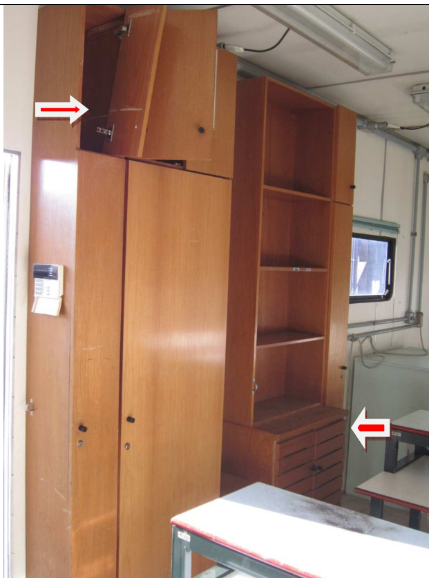
Figura 10: Dobradiças quebradas e portas soltas.
