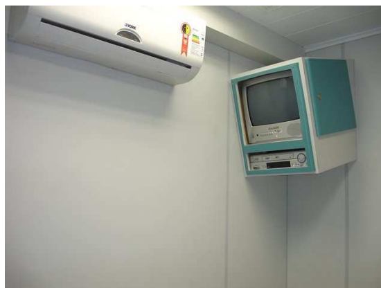
Figura 43: Suporte para TV e ar-condicionado com parafusos ocultos Fonte: Jardim (2010)
