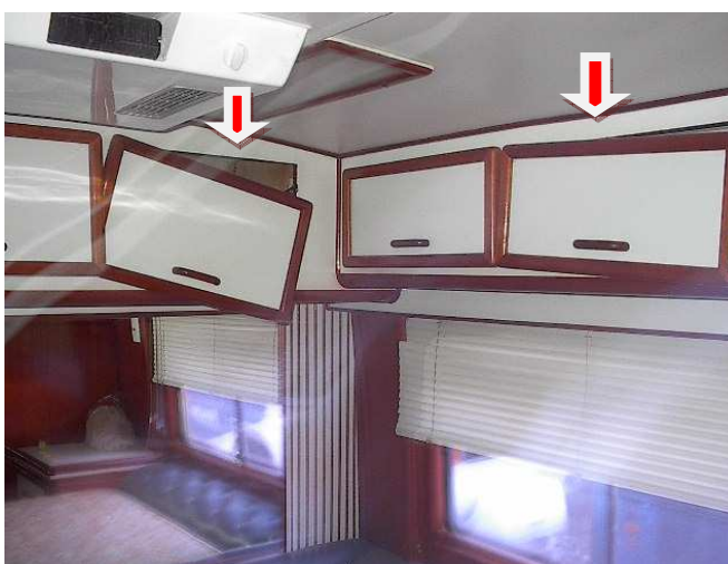
Figura 3: Portas danificadas e desalinhadas
