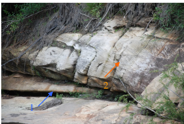
Foto 103: Fraturas horizontais (1) e verticais (2)
