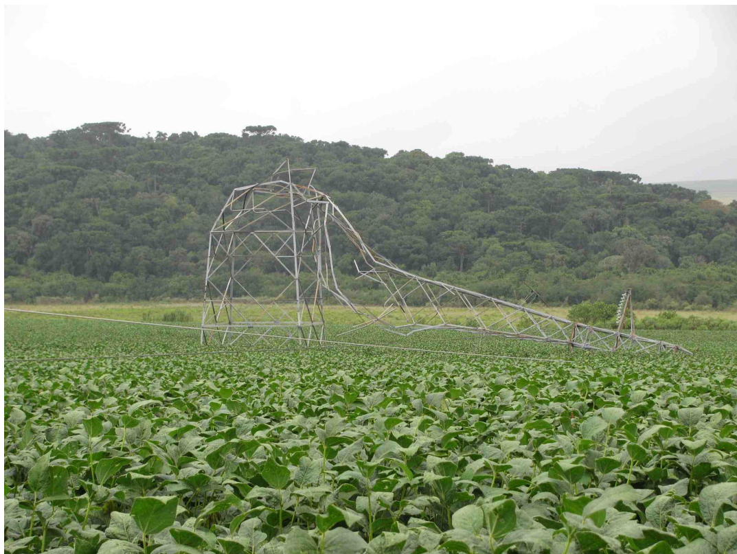
FIGURA 4-1 – QUEDA DA ESTRUTURA 93 DA LT IRATI – SABARÁ
