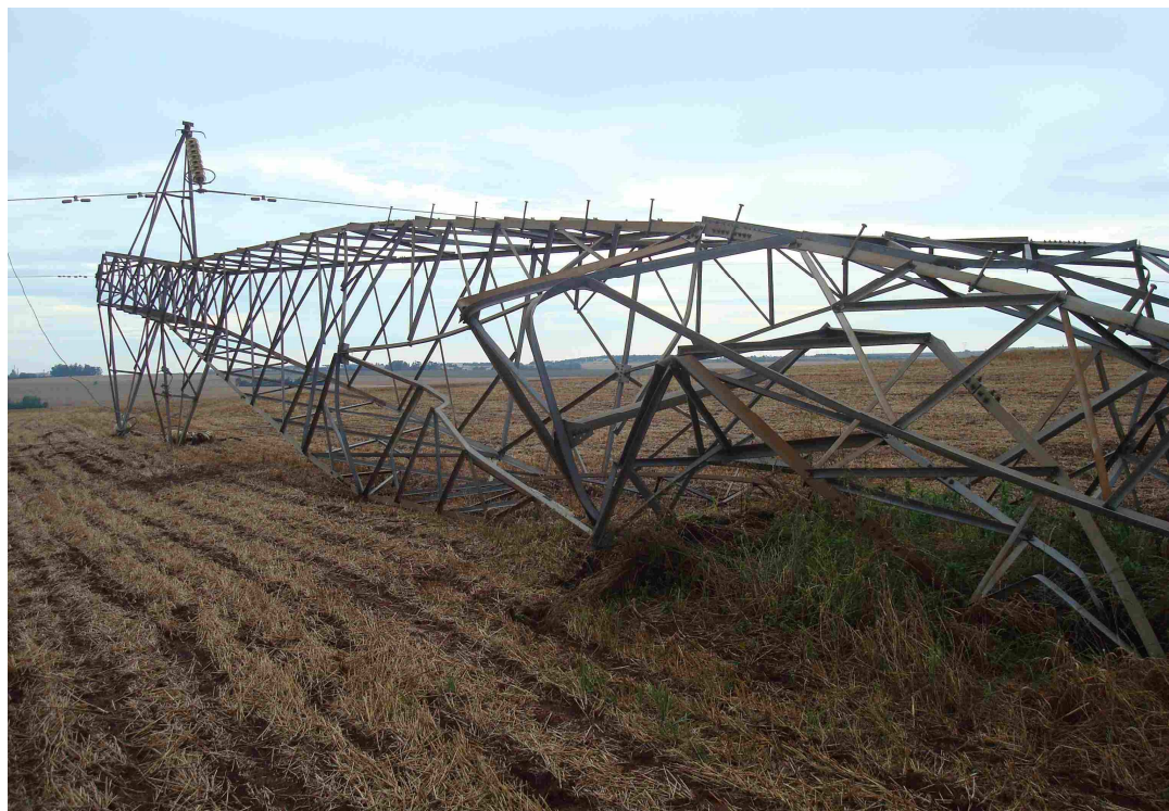
FIGURA 4-2 – QUEDA DA ESTRUTURA 34 DA LT MEDIANEIRA – CÉU AZUL
