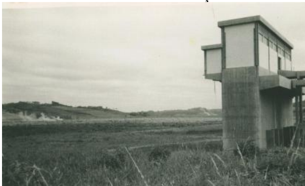
FIGURA 25 - TORRE DE CAPTAÇÃO
