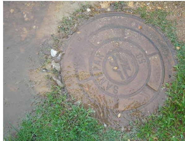
FIGURA 51 - POÇO DE VISITA EM SÃO JOSÉ EXTRAVAZANDO
