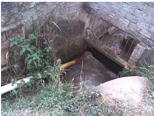
FIGURA 50 - ESGOTO EM GALERIA DE ÁGUA PLUVIAL EM SÃO JOSÉ
