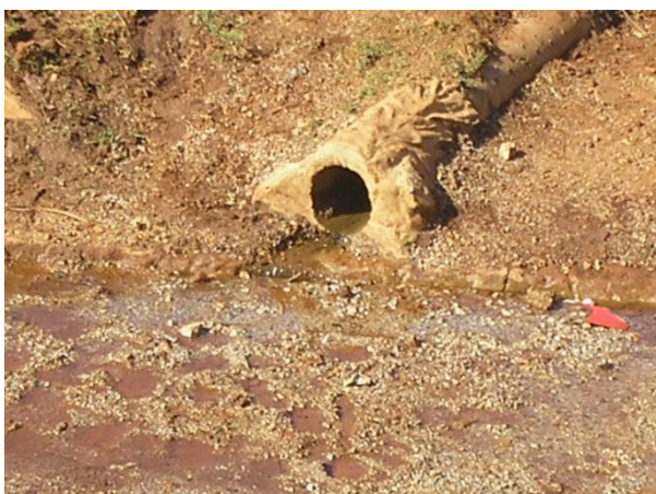
FIGURA 54 - ESGOTO LANÇADO NA RUA EM SÃO JOSÉ
