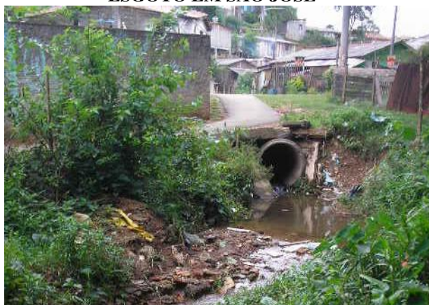
FIGURA 46 - REDE ÁGUA PLUVIAL COM ESGOTO EM SÃO JOSÉ
