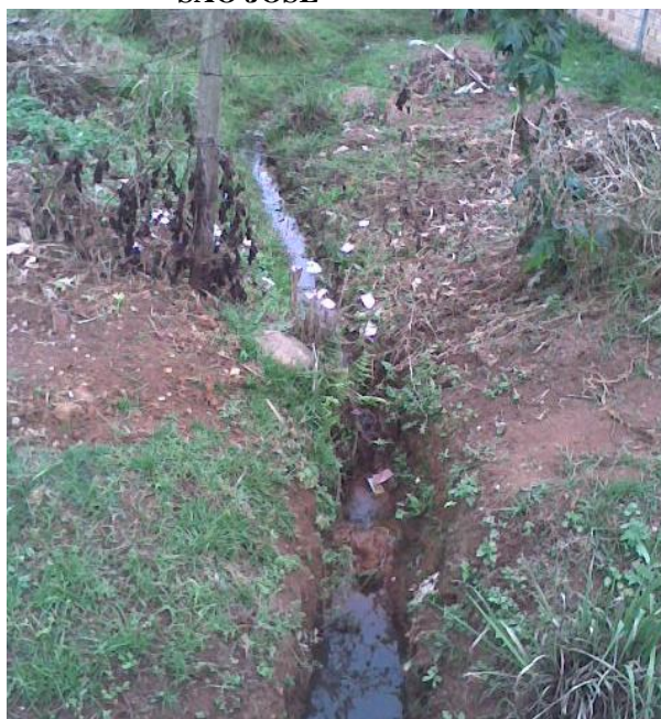
FIGURA 49 - ESGOTO À CEU ABERTO EM SÃO JOSÉ
