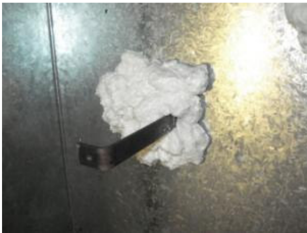
Detalhe do gancho de suporte da tubulação
