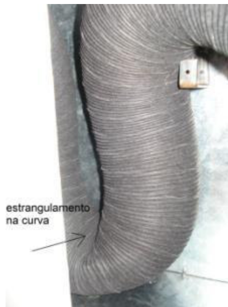
FIGURA 51 – Tubulação acústica TA2 com estrangulamento na curva
