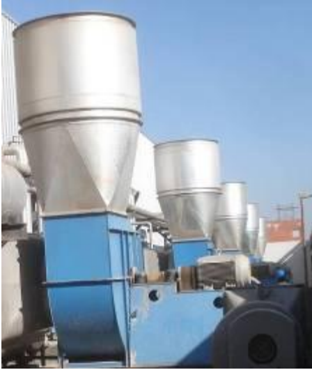
FIGURA 42 – ÁREA DOS VENTILADORES DO MEZANINO FONTE: O autor (2010)
