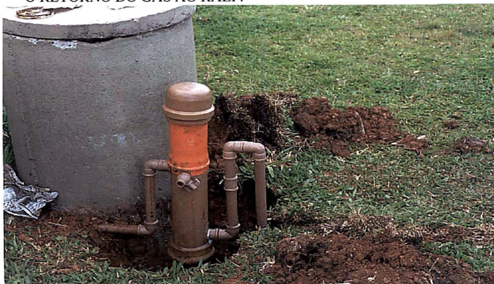
FIGURA 16 - VISTA DO SELO HÍDRICO LOCALIZADO PRÓXIMO À ESTUFA PARA EVITAR O RETORNO DO GÁS AO RALF.
