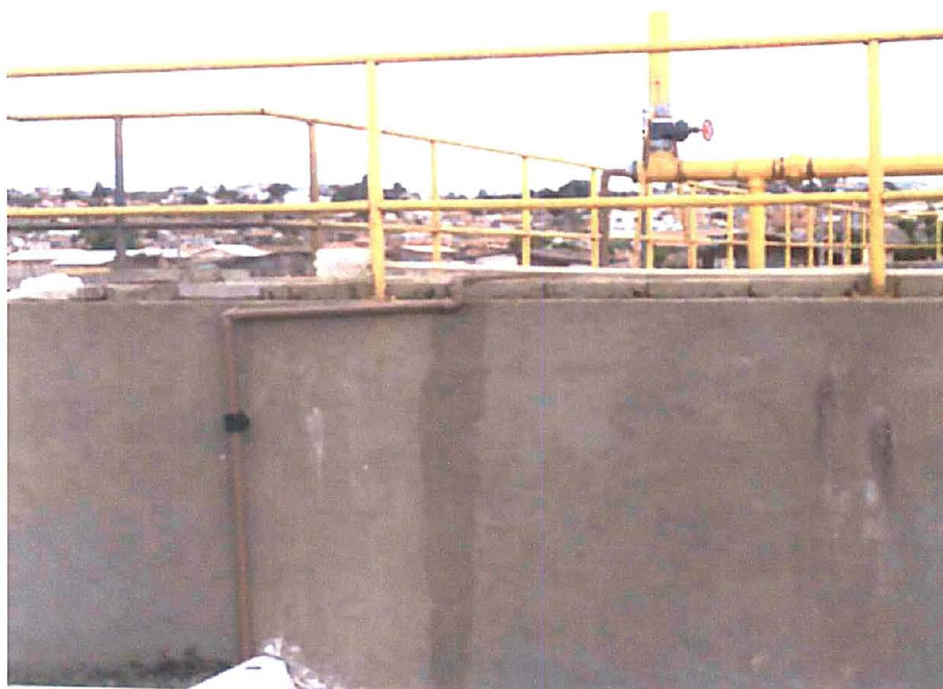
FIGURA 15 - TUBULAÇÃO DO BIOGÁS EM PVC COM SAÍDA DO RALF PARA A ESTUFA.
