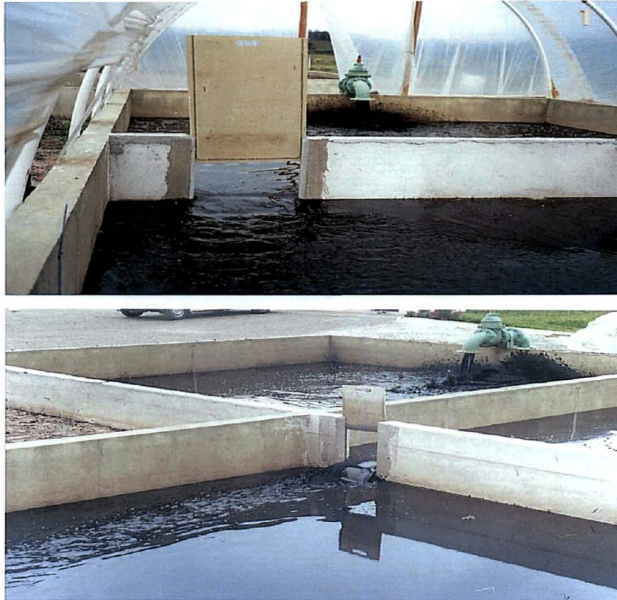
FIGURAS 13 E 14 – MOMENTO DA DESCARGA DE LODO E DIVISÓRIA DOS LEITOS DE SECAGEM.
