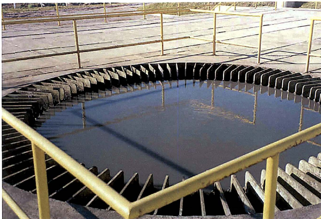
FIGURA 11 – ENTRADA DO REATOR ANAERÓBIO
