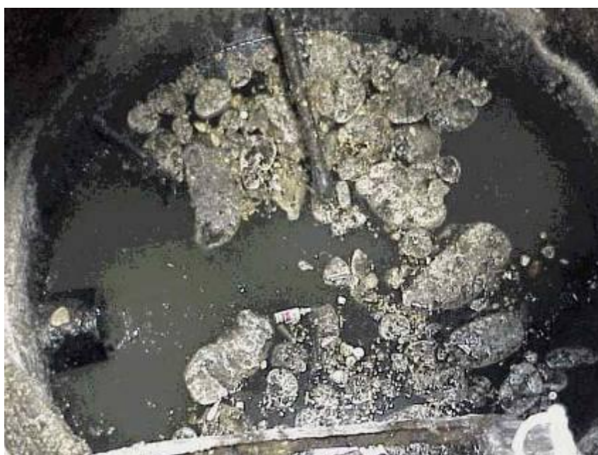
Figura 12. Material agregado proveniente da mistura de óleos, gorduras e partículas sólidas flutuando em uma caixa de gordura convencional. Fonte: SENAI CIC.
