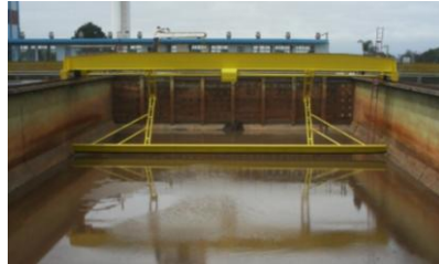
FIGURA 17-DECANTADOR E RASPADORES MECANIZADOS DA ETA IGUAÇU - FONTE: A AUTORA
