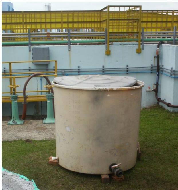
FIGURA 29 - TANQUE PARA HOMEGEINIZAÇÃO DO LODO FONTE: A AUTORA
