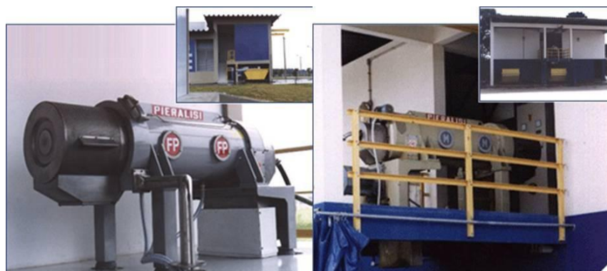
FIGURA 27 - CENTRÍFUGAS DAS ETAS IRAÍ E PASSAÚNA FONTE: PIERALISI (2009a)
