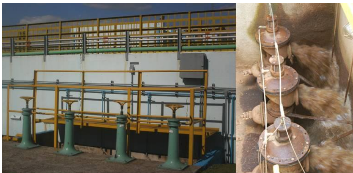
FIGURA 28 - ETA IGUAÇU: DESCARGA DE LODO DOS DECANTADORES FONTE: A AUTORA
