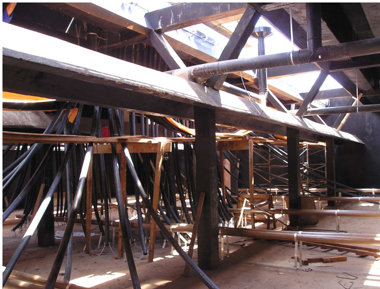
FIGURA 4.4 – VISTA DAS TUBULAÇÕES DISTRIBUIDORAS NO INTERIOR DO REATOR FONTE: SANEPAR (-).
