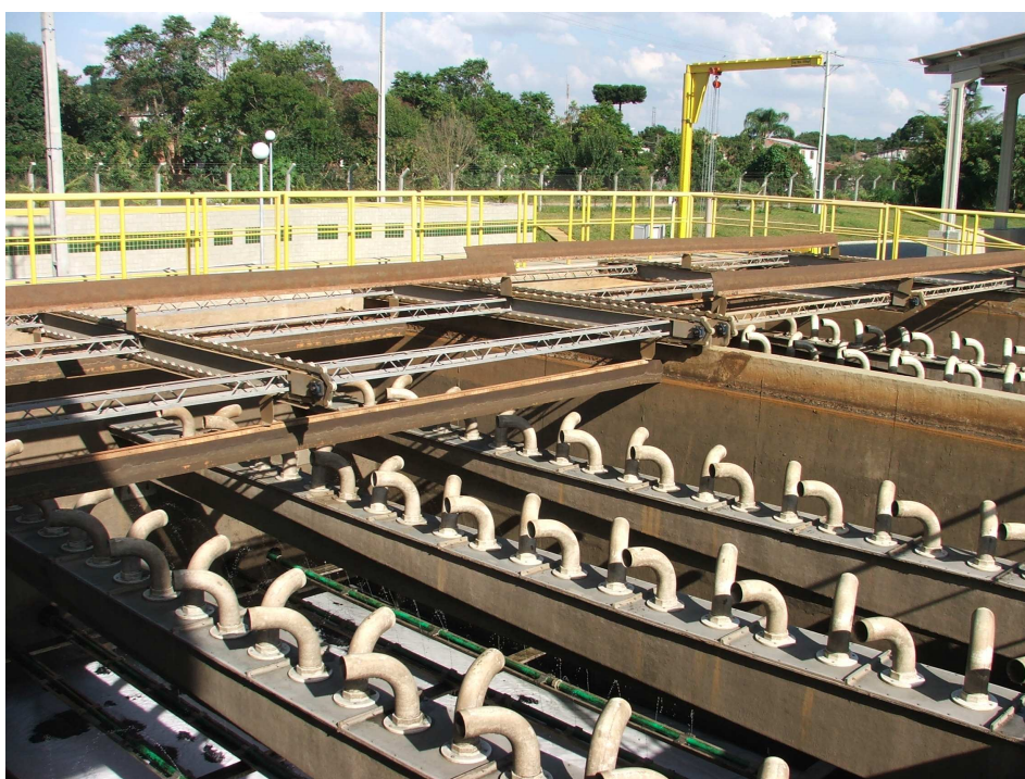
FIGURA 4.5 – VISTA DO SISTEMA FAD DA ETE A – DESTAQUE PARA OS RASPADORES DE LODO E SAÍDA DE ÁGUA FLOCULADA FONTE: AUTORA (2010).
