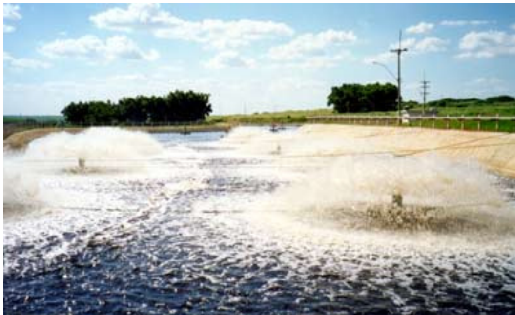
Figura 01- Vista geral do Sistema Aerado.
