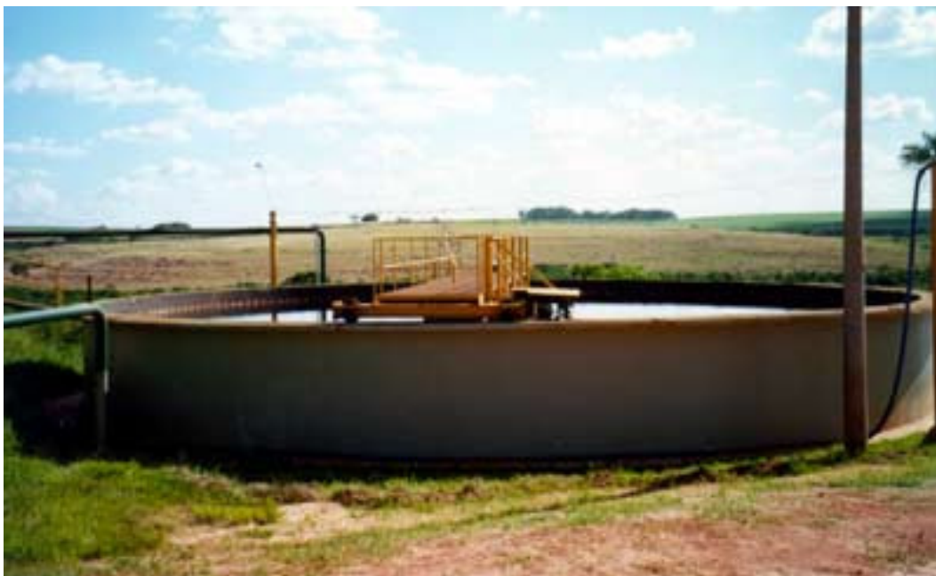
Figura 02- Sistema para decantação de resíduos sólidos da vinhaça
