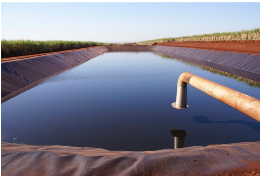
Figura 14 - Lagoa de vinhaça no solo com revestimento impermeável (semelhante) Fonte - Koerner (1994)
