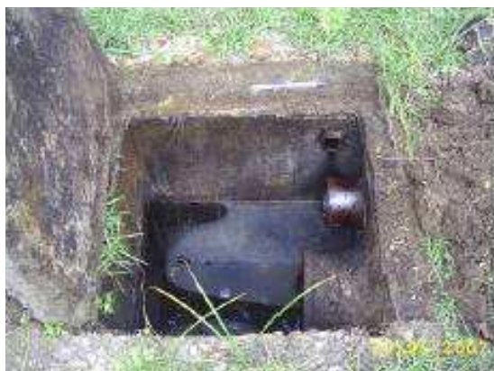
FIGURA 18– CAIXA DE PASSAGEM CONTENDO ÓLEO
