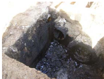
Imagem 01 - Caixa de inspeção na saída do laboratório com a tubulação rompida.
