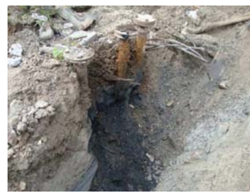
Imagem 05 - Tubulação desativada contendo produtos e causando contaminação.
