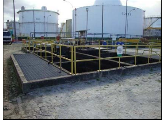
FIGURA 13 –O SISTEMA DE SEPARAÇÃO T.P.I SITUADO NA ÁREA 35, PRÓXIMO AO PRÉDIO DO ALMOXARIFADO
