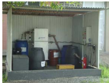
Imagem 02 - Poço de bombeamento utilizado na remediação da Z-1.
