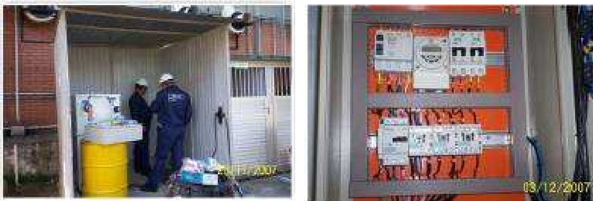
FIGURA 22 - DETALHES INTERNOS DO SISTEMA DE BOMBEAMENTO INSTALADO: PAINEL DE COMANDO DE FORÇA E DEMAIS EQUIPAMENTOS; ABRIGO ONDE OS TAMBORES E POÇO DE ESGOTAMENTO SE ENCONTRAM. FONTE: Relatório ESSENCIS (ETR 200901260900CBJ) – Projeto Conceitual de Remediação 2009
