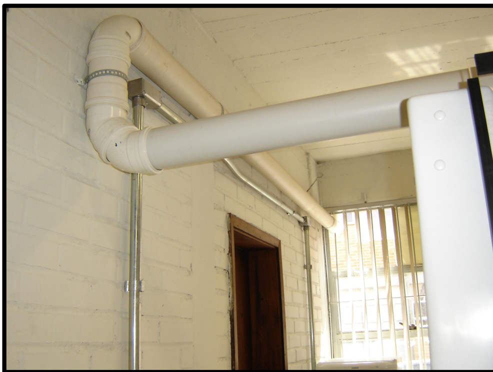
Figura 32 - Vista de um dos dutos de saída de ar do LTA após as modificações.
