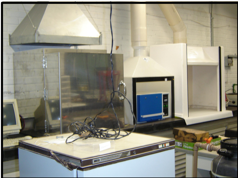
Figura 21 - Vista dos novos equipamentos, fornos e coifas para a saída do ar.
