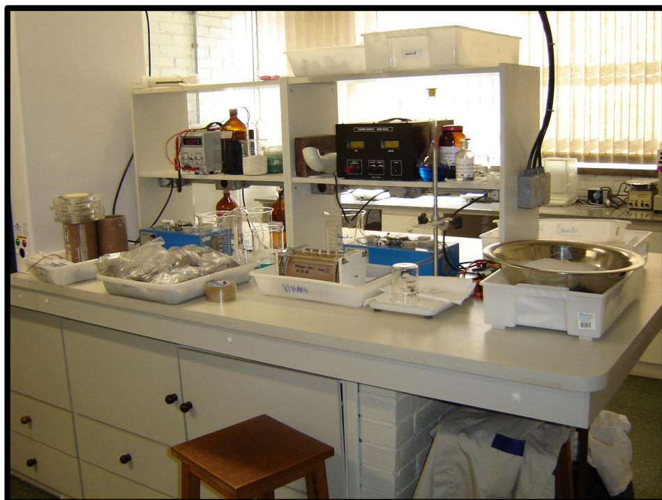
Figura 30 - Vista das bancadas e equipamentos do LTA após as modificações e readequação dos circuitos elétricos.
