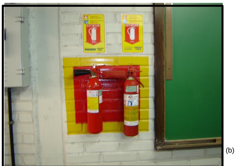
Figura 23 - Vista da demarcação dos extintores do LTA.
