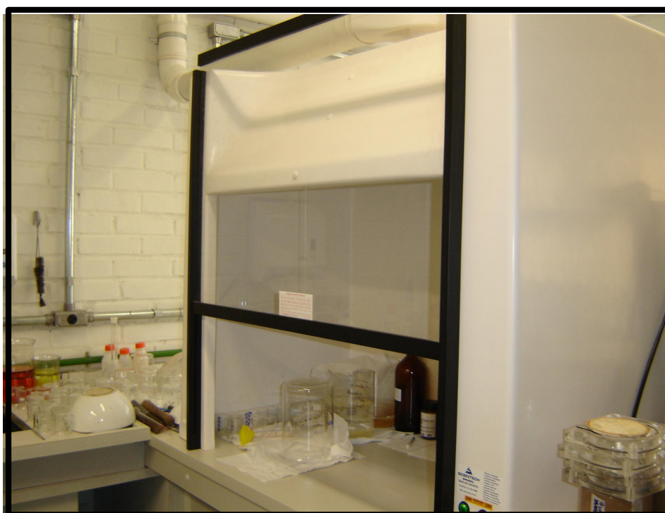
Figura 31 - Vista das bancadas do LTA após as modificações, com a instalação de capela para exaustão.
