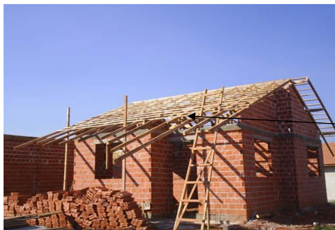
FIGURA 4.30 - CAIBROS COM COMPRIMENTO EXCESSIVO
