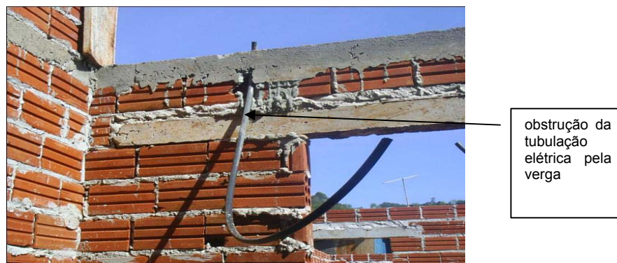
FIGURA 4.22 -PASSAGEM PARA TUBULAÇÃO ELÉTRICA OBSTRUÍDA PELA VERGA
