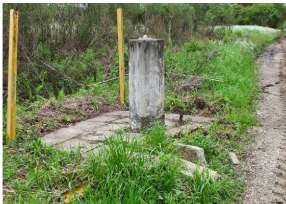
Figura 16 - Avaria na base do pilar P5 FONTE: O autor
