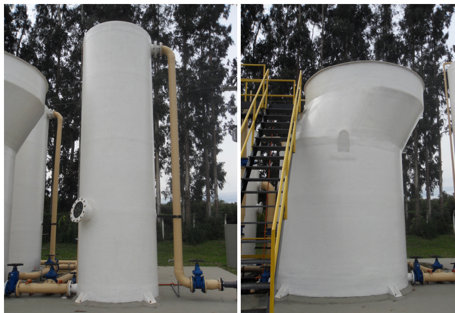
FIGURA 21 - VISTA DA CÂMARA DE OZONIZAÇÃO (ESQUERDA) E DO FLOCO DECANTADOR (DIREITA) DA URA DA ETE ATUBA SUL
