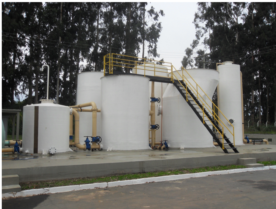
FIGURA 20 - VISTA GERAL DA URA DA ETE ATUBA SUL
