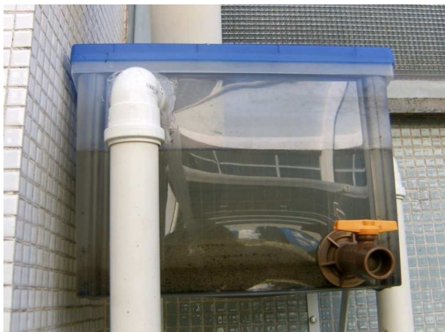
FIGURA 17 – RESERVATÓRIO DE DESCARTE DO ESCOAMENTO INICIAL FONTE: O AUTOR (2010)
