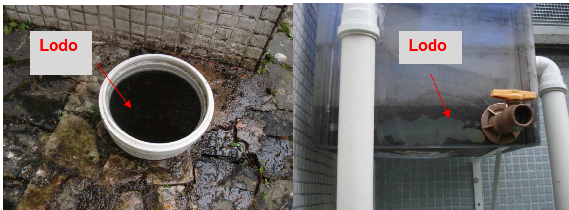
FIGURA 29 – LODO ACUMULADO NO CAP E NO RESERVATÓRIO DE DESCARTE INICIAL FONTE O AUTOR (2010)
