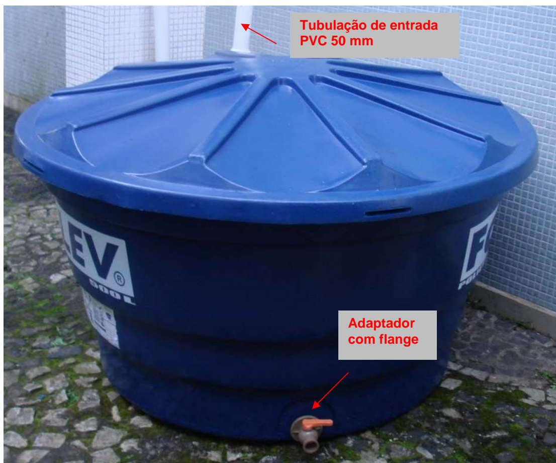
FIGURA 18 – RESERVATÓRIO DE DETENÇÃO DA ÁGUA DE CHUVA FONTE: O AUTOR (2010)
