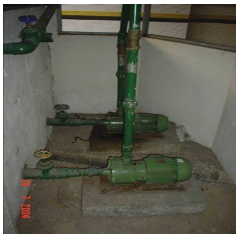
FIGURA 4.14 – CONJUNTO MOTOR-BOMBA DE RECALQUE
